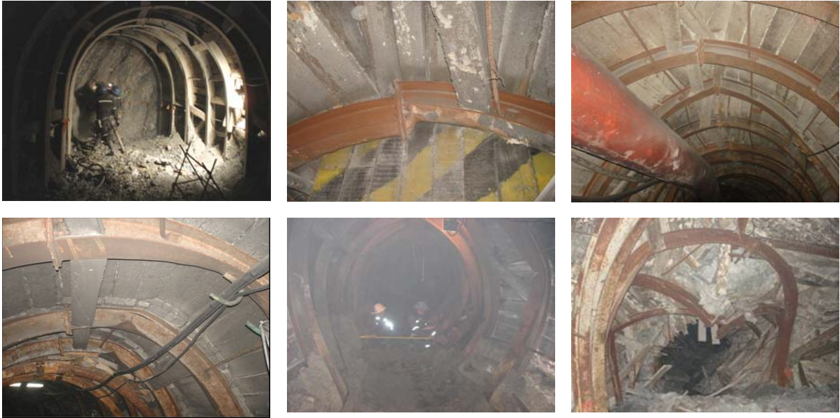
Fotos del comportamiento de las cimbras 6H20. Proceso de deformación de las cimbras.
