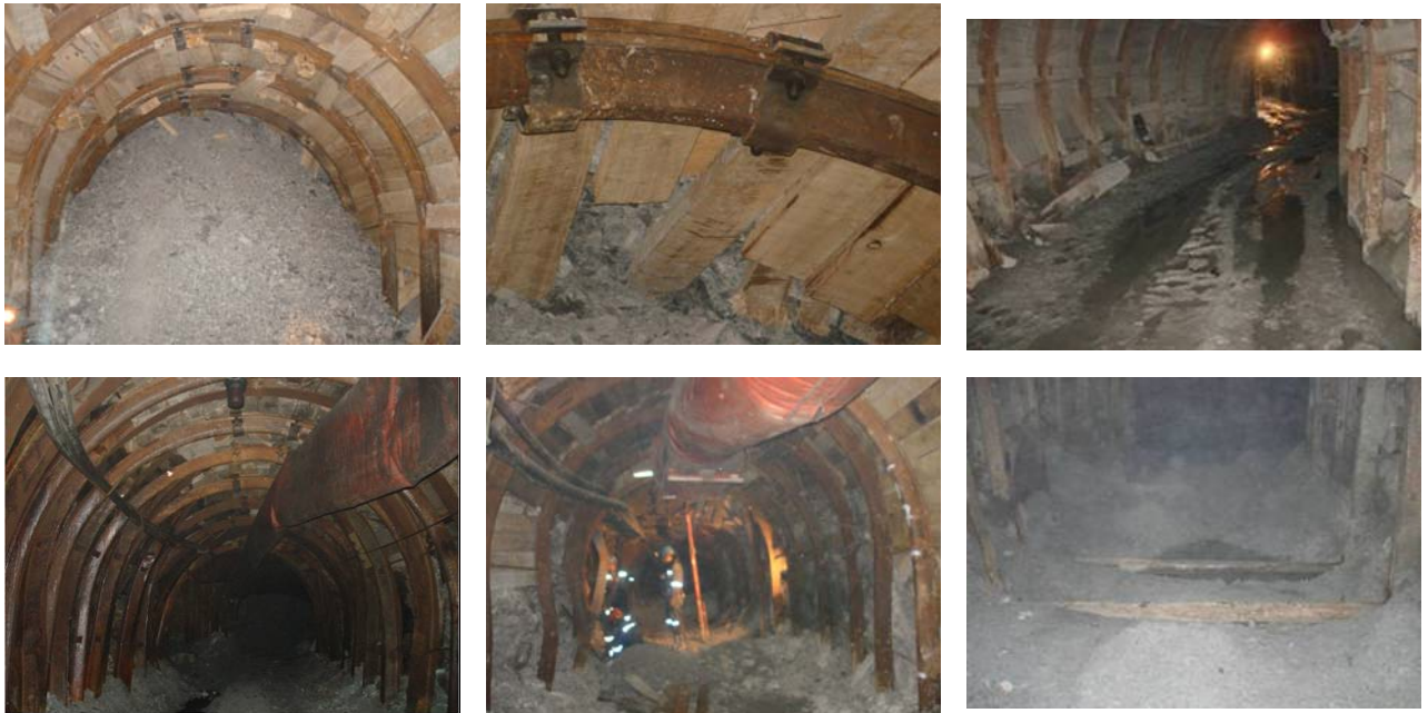
Fotos del comportamiento de las cimbras THN-29. Proceso de deformación de las cimbras
