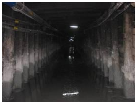
Foto 7.1: Agua en la bocamina Nv 4090 – Año 2004
