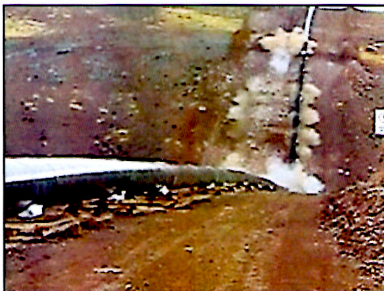
Voladura tapada sin daño a tubería soldada a menos de 2 metros
