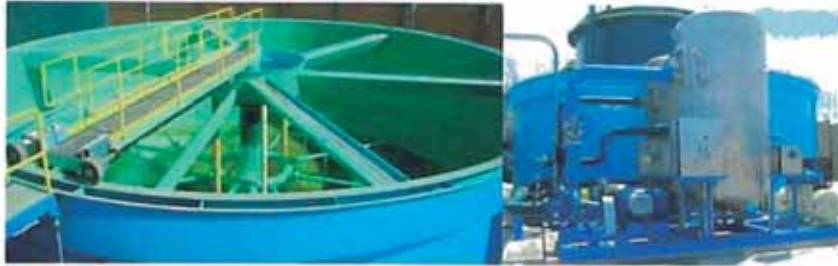
Figura 5.18 Recuperación Secundaria - Sistema de Floculación aire disuelto
