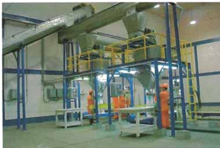
Figura 5.13 Sala de ensaque.
