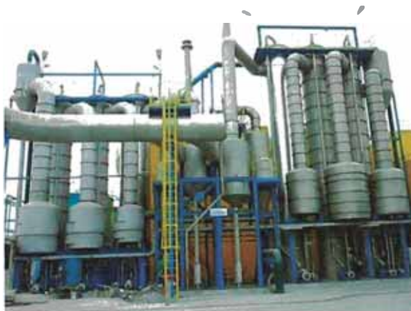
Figura 5.16 Planta de Agua de Cola o Evaporadora
