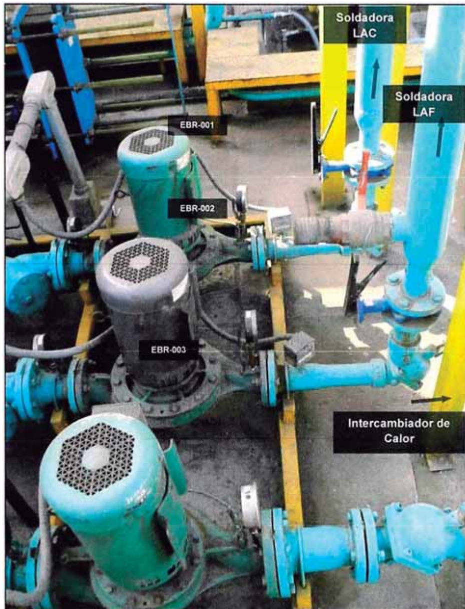
Figura 3.21: Bombas de Impulsion de Agua Industrial
