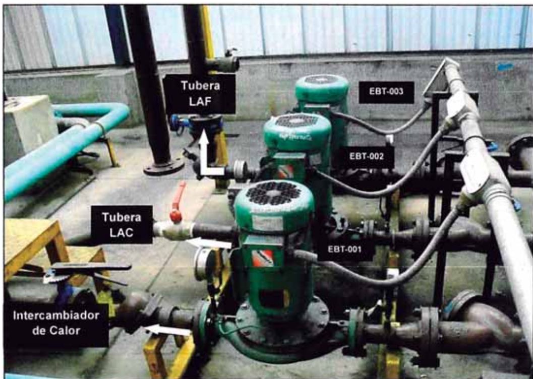
Figura 3.22: Bombas de Impulsión de Agua Industrial
