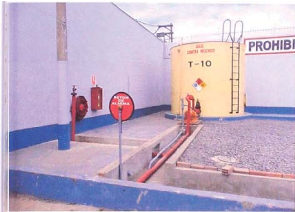
Tanque de Agua Contra Incendio
