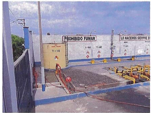
Tanque de Agua y Bomba C.I.
