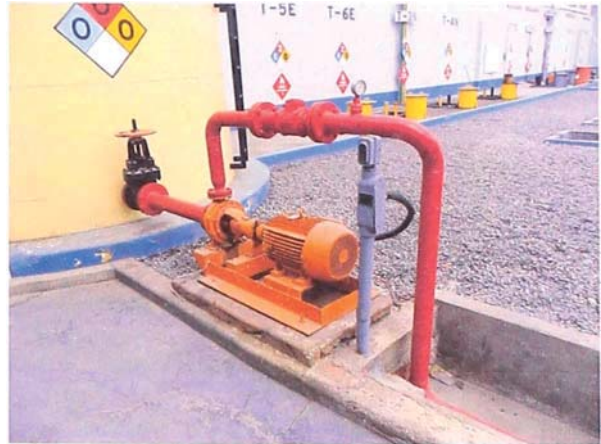
Bomba de Agua Contra Incendio
