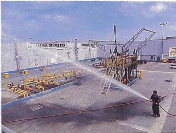
Chorro de la Manguera de Agua Contra incendio
