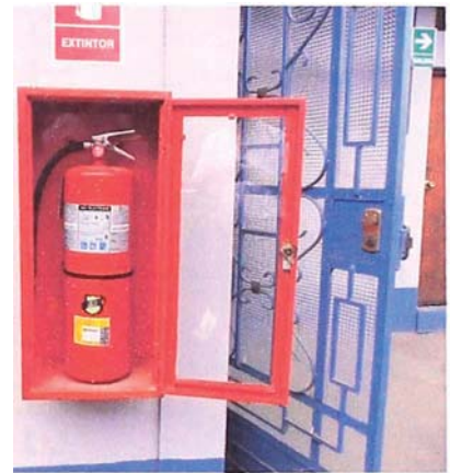
Extintor de 30 libras
