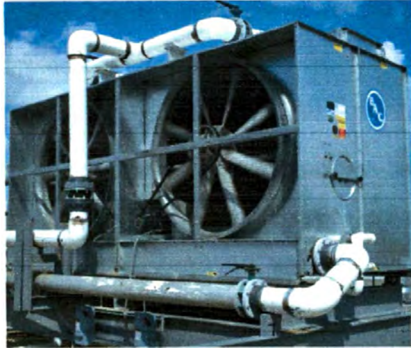
FIG. 37 TORRE DE ENFRIAMIENTO.
