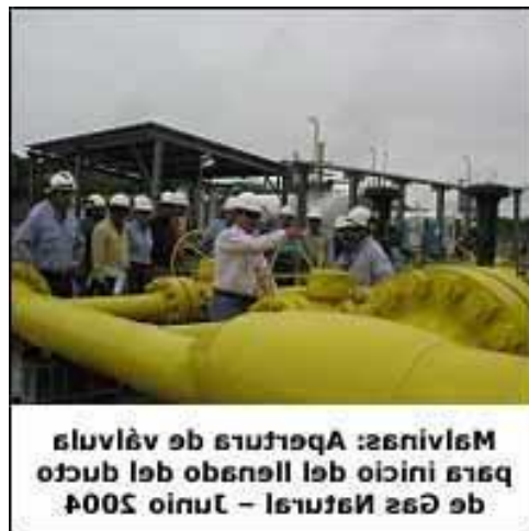
Fig. 2: Apertura de la válvula en Malvinas
