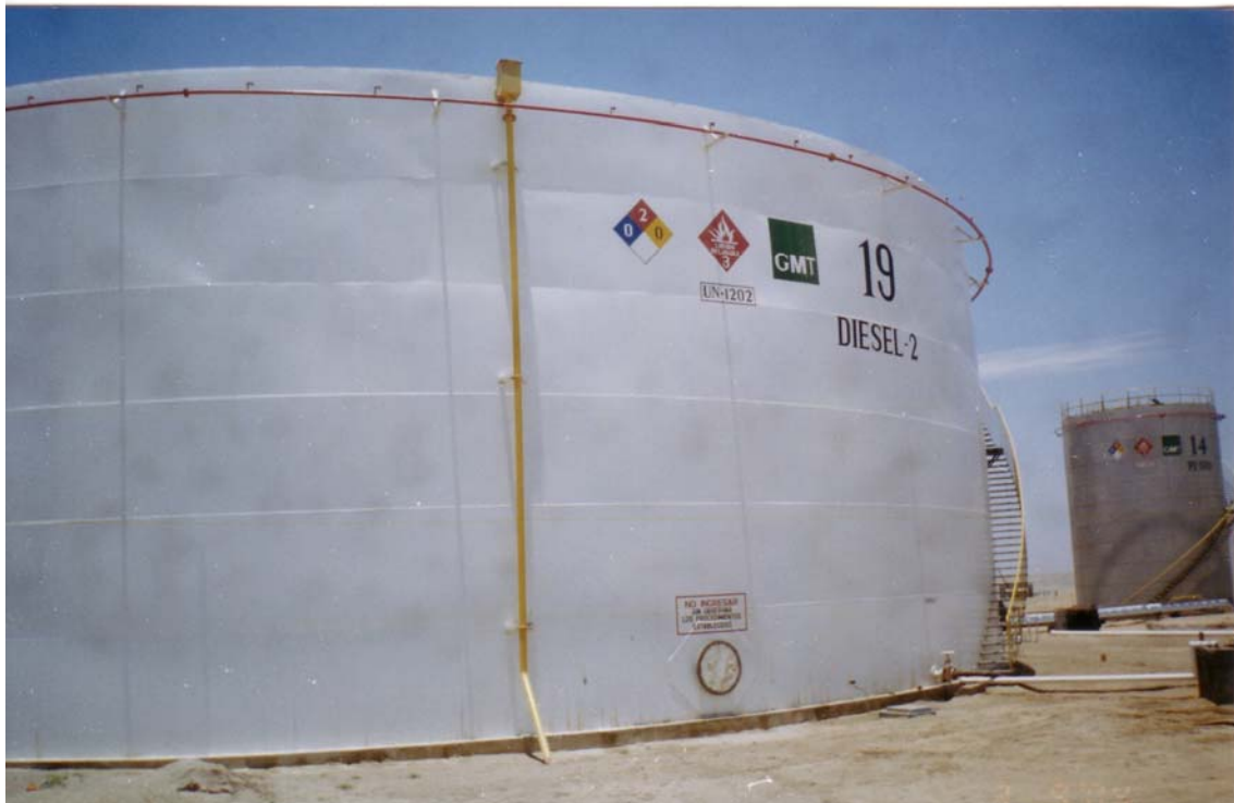
Figura 3.18: Tanque con Cámara de Espuma
