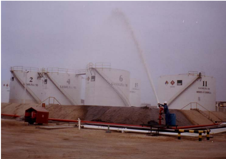
Figura 3.13: Se Observa el Lanzamiento del Chorro de un Monitor
