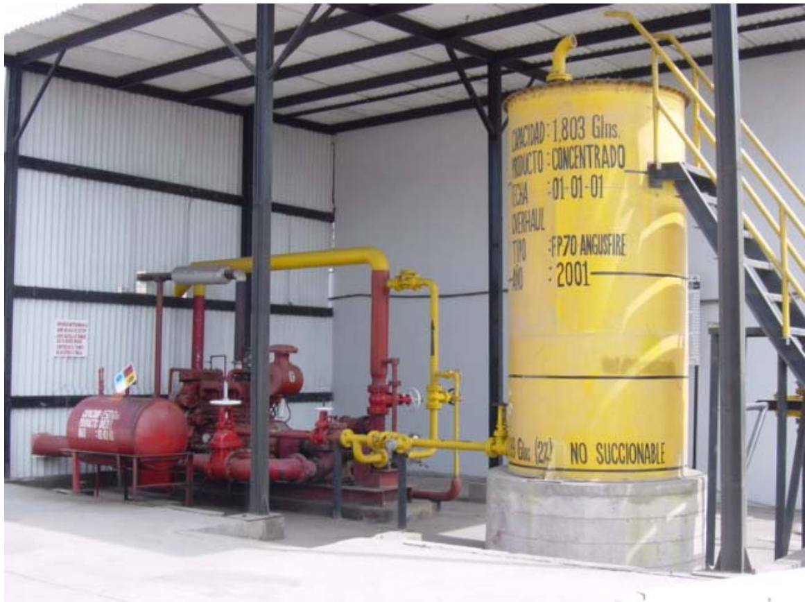
Figura 3.19: Tanque de Concentrado de Espuma
