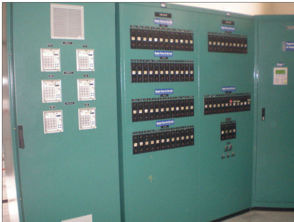
Figura Nº 3.22 Aparatos de Señalización y Alarma instalados en la Sala de Mando.
