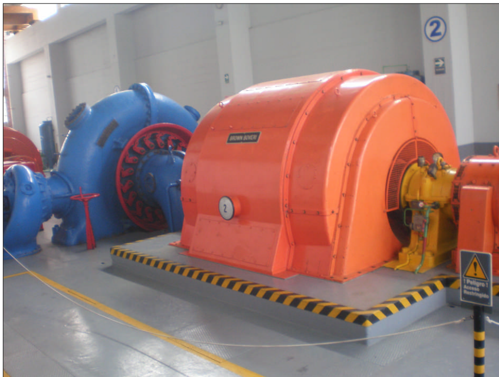
Figura N° 3.24 Alternador de una Central Hidroeléctrica (Huampani)
