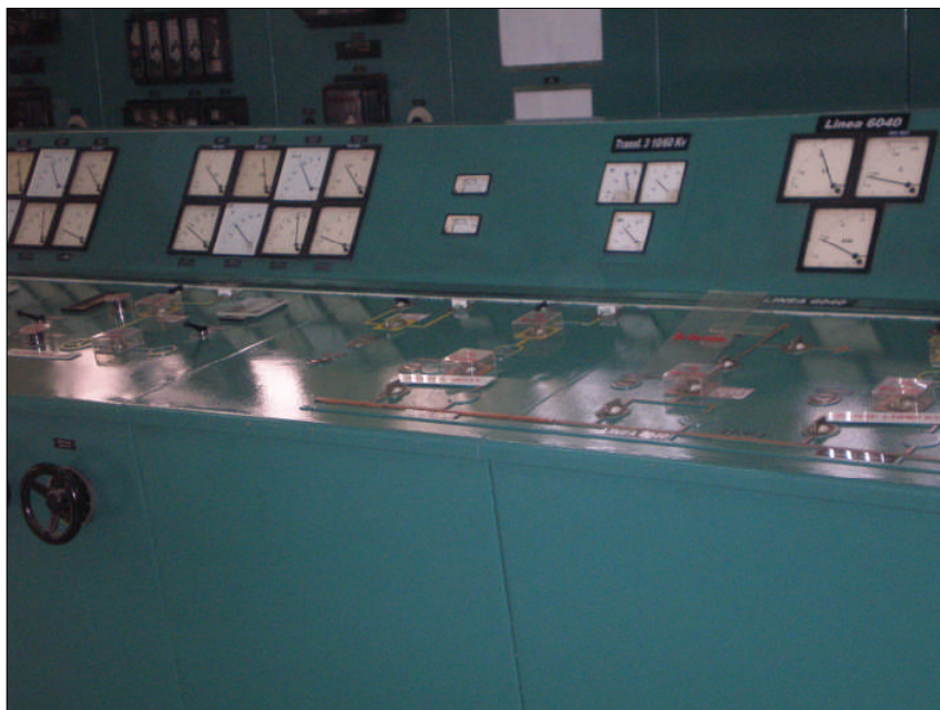
Figura N° 3.18 Instrumentos de Medición instalados en la Sala de Mando.
