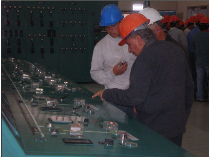
Figura N° 3.17 Tablero de Control en la Sala de Mando
