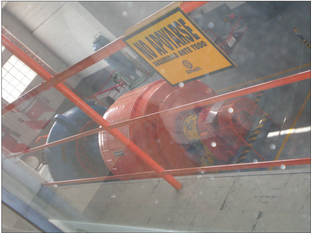
Figura Nº 3.21 Grupo Generador Hidráulico de una Central Hidroeléctrica (Huampani)
