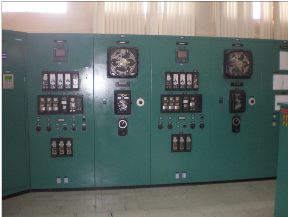
Figura N° 3.23 Panel de los Relés instalados en la Sala de Mando.
