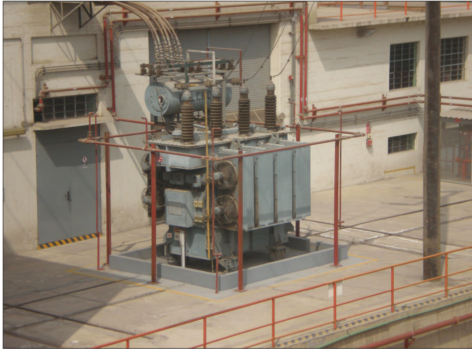
Figura N° 3. Transformador de Potencia de una Central Hidroeléctrica (Huampani)
