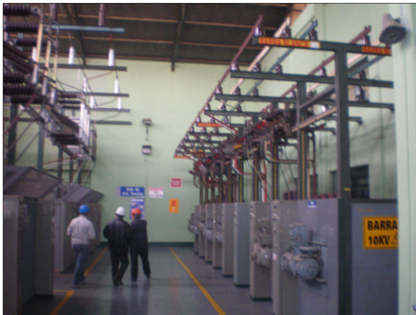
Figura N° 3.20 Patio de Llaves de la Central Hidroeléctrica (Huampani)
