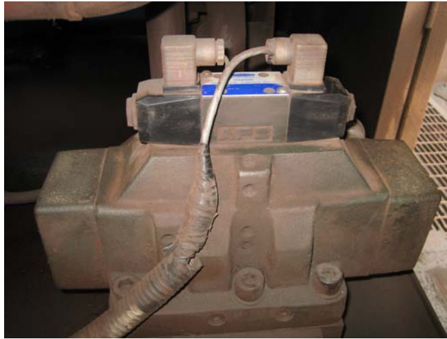
Figura 3.13 Válvula de control
