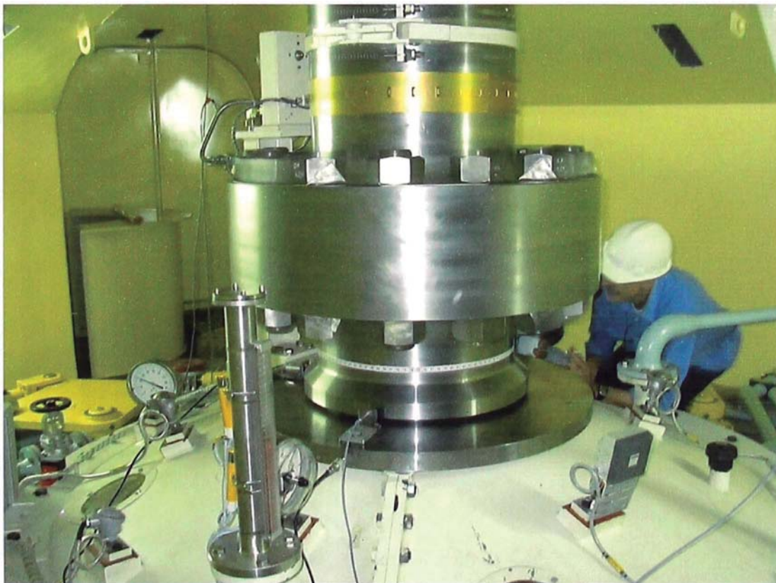
Foto No.02.- Primer giro de la Unidad 1 (brida de unión de turbina y generador)
