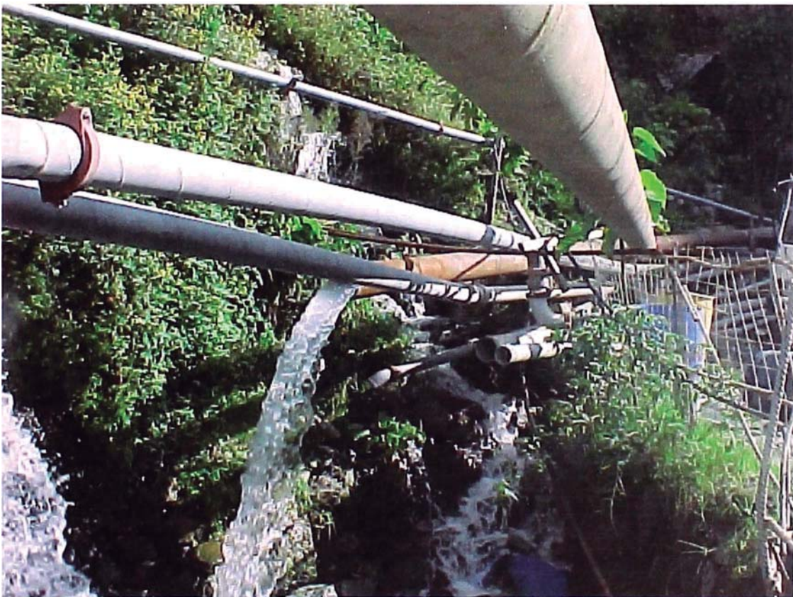
Foto No.12.- Agua Subterránea del Túnel 4 – Ventana No.3 derivada al río Paucartambo sin tratamiento alguno
