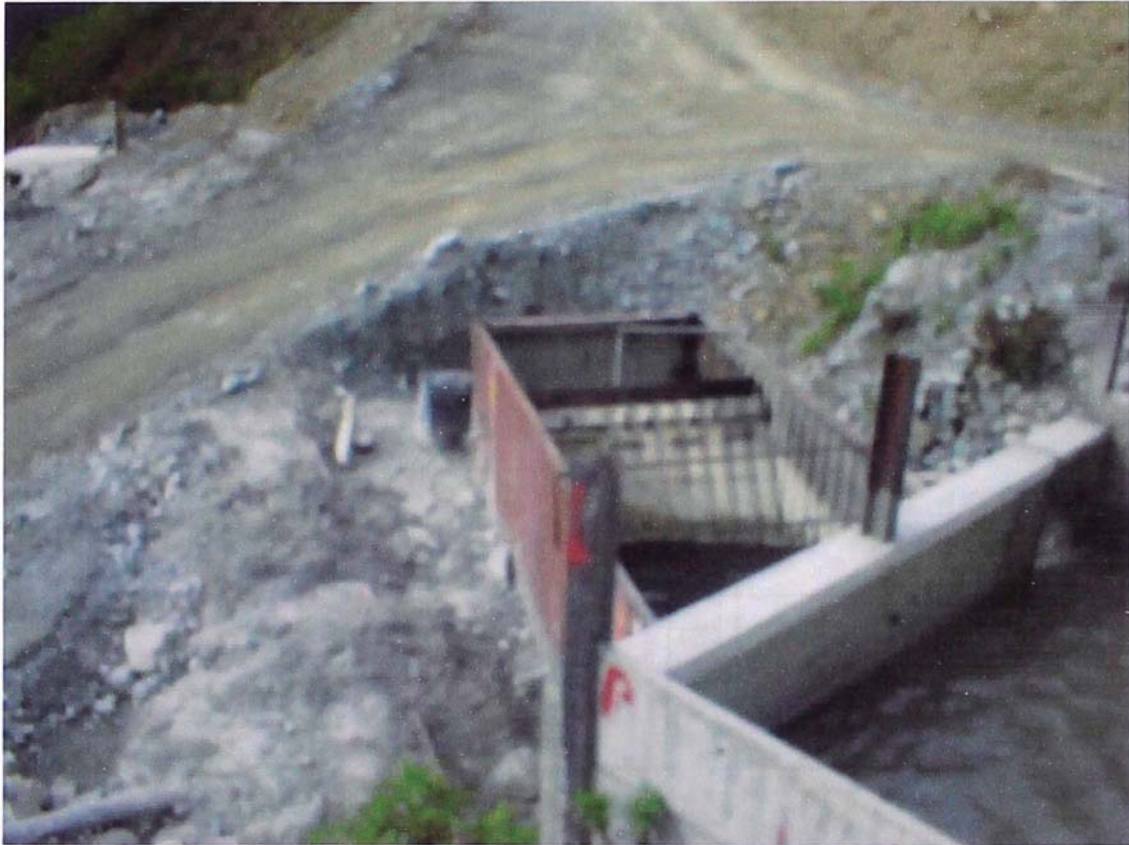
Foto No.23 – Sistema mixto Tanque de sedimentación – Tratamiento de aceite y grasas – Túnel No.04 Penstock
