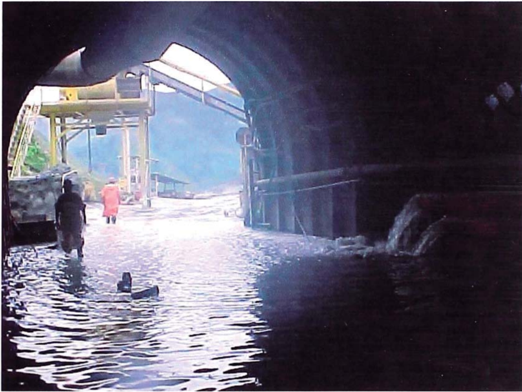
Foto No.09.- Incremento extraordinario del caudal del agua subterránea - Túnel No.04
