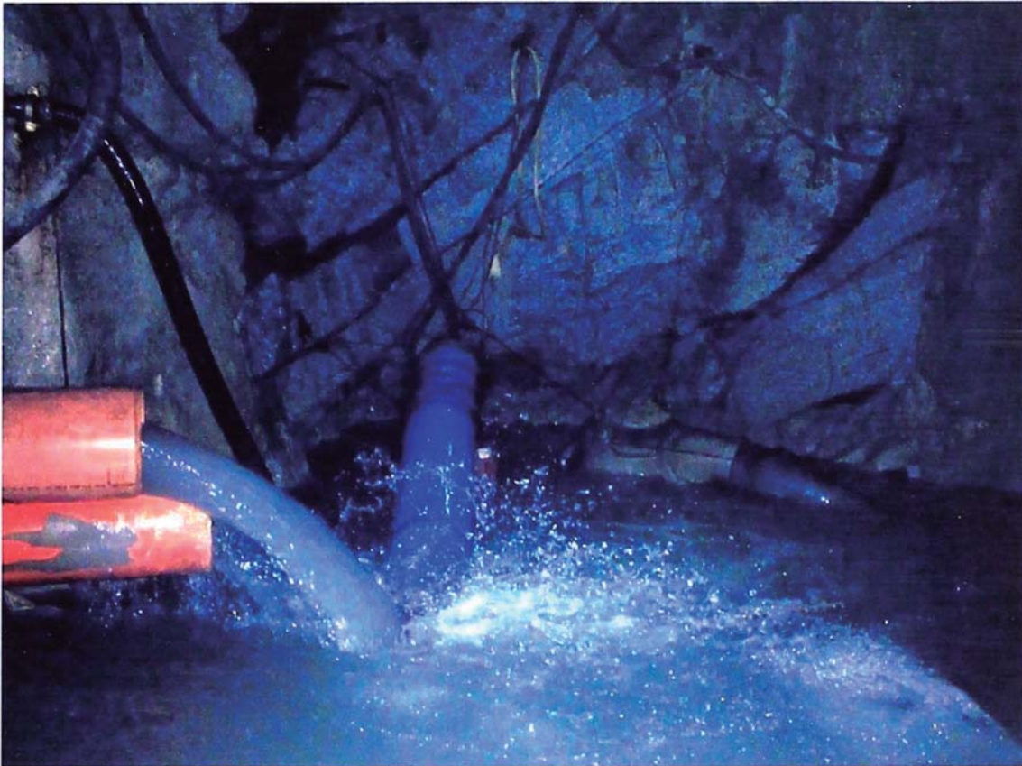
Foto No.07.-Caudal agua Subterránea – Túnel No.04 Penstock
