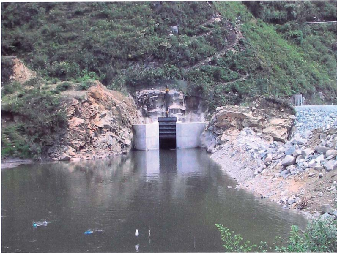
Foto 13.- Derivación del río Paucartambo a través del Túnel de derivación a fin de iniciar los trabajos de excavación de la Presa Huallamayo
