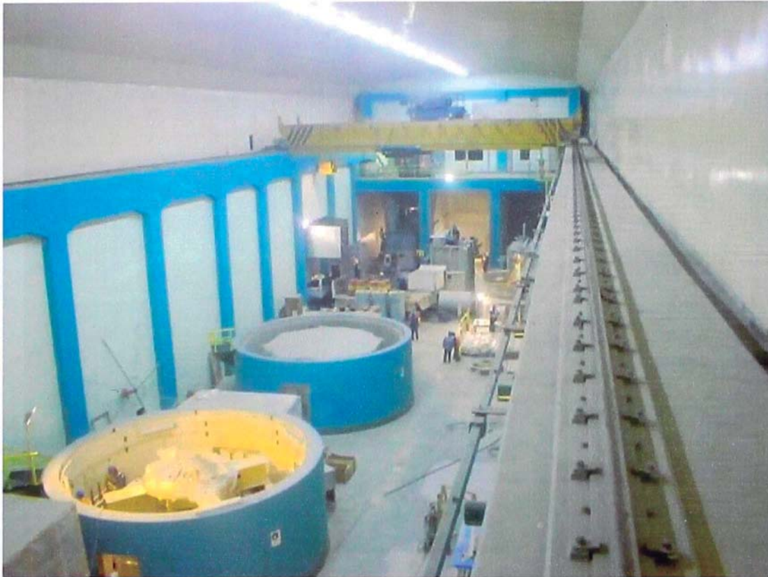
Foto No.01.-Casa de Máquinas – Central Hidroeléctrica Yuncan
