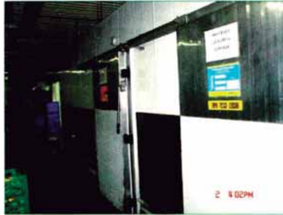
CAMARAS DE REFRIGERACION
