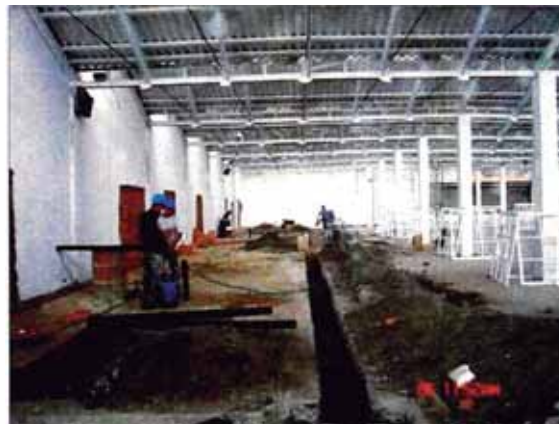
DUCTOS DE ENERGIA ELECTRICA
