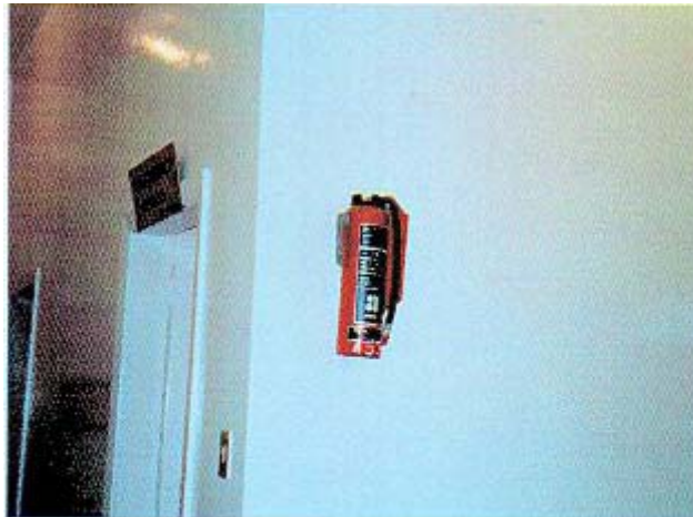
Foto NO.58 Extintor sin señalización en el laboratorio.
