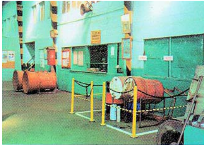
Foto NO.52 Instalación típica de lubricantes dentro de talleres.
