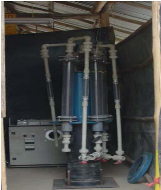
Fig. 28 Circuito de adsorción- Planta Piloto
