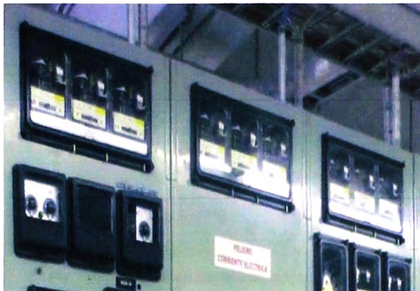
Fig. 3.7 Relé electromecánico existente.
