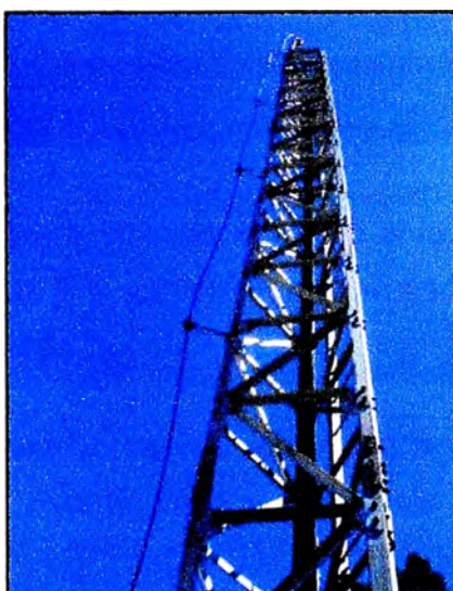
Figura 3.30 Descenso del cable desnudo del pararrayos
