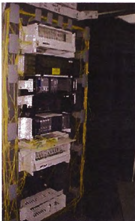
Figura 2.4 Hub de Distribución – Vista interna del Hub con los equipos instalados
