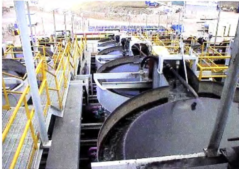
FIGURA 10. Vista del tren 2 del circuito de Adsorción # 1
