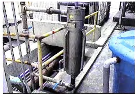
FIGURA 26. Filtro en bombeo a Merrill Crowe
