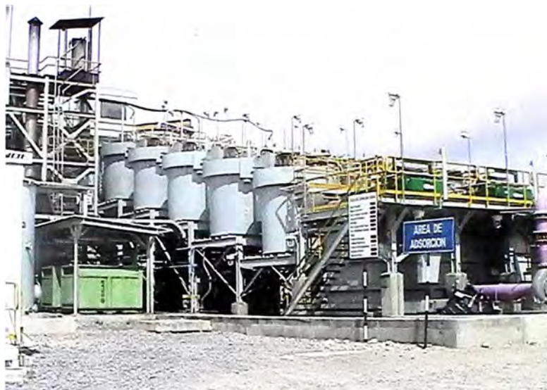
FIGURA 9. Vista panorámica del circuito de adsorción # 1
