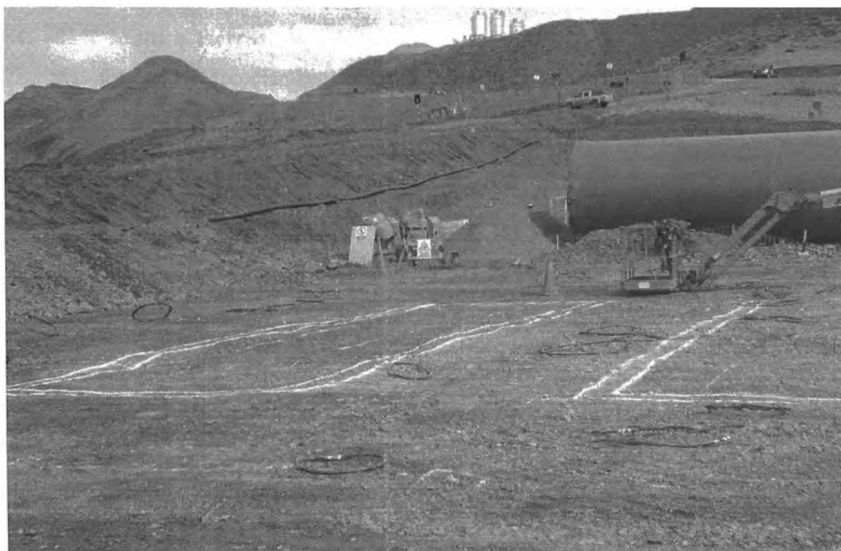
Foto 6- Vista donde se puede apreciar las mechas dejadas para aterramiento.
