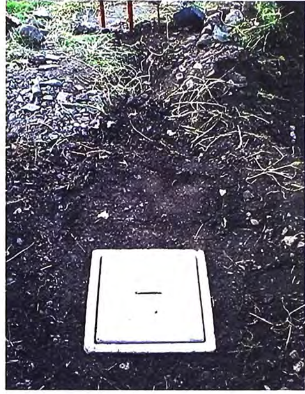
b) Caja de Registro de Pozo a Tierra
