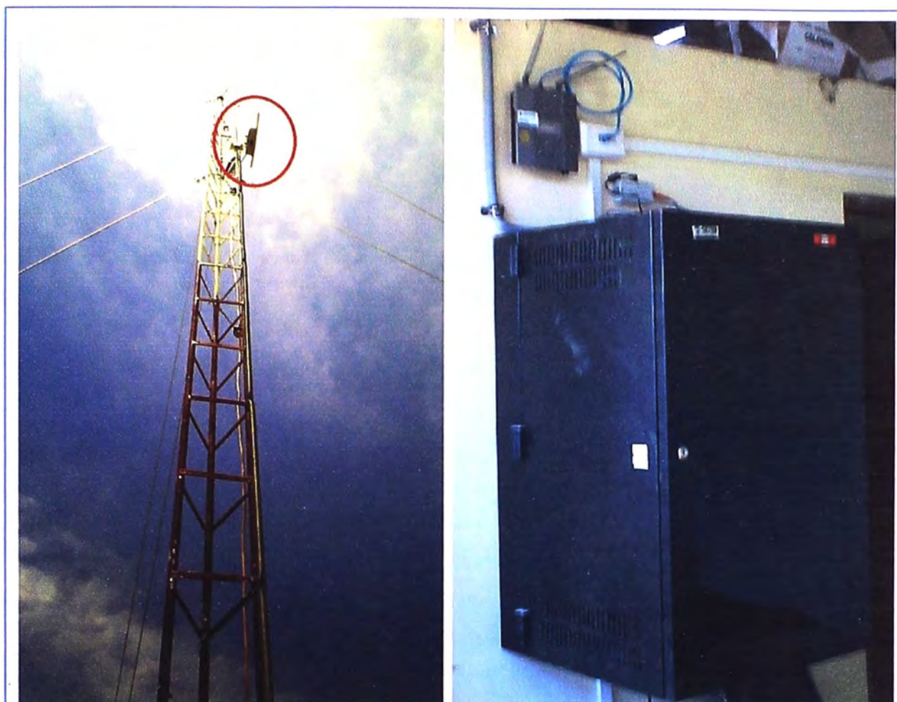
a) Antena instalada en torre
