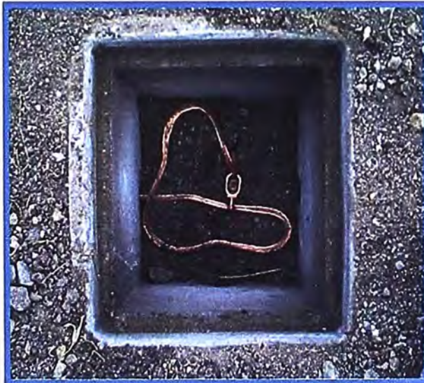
a) Conexion de Cable Pararrayo a Tierra
