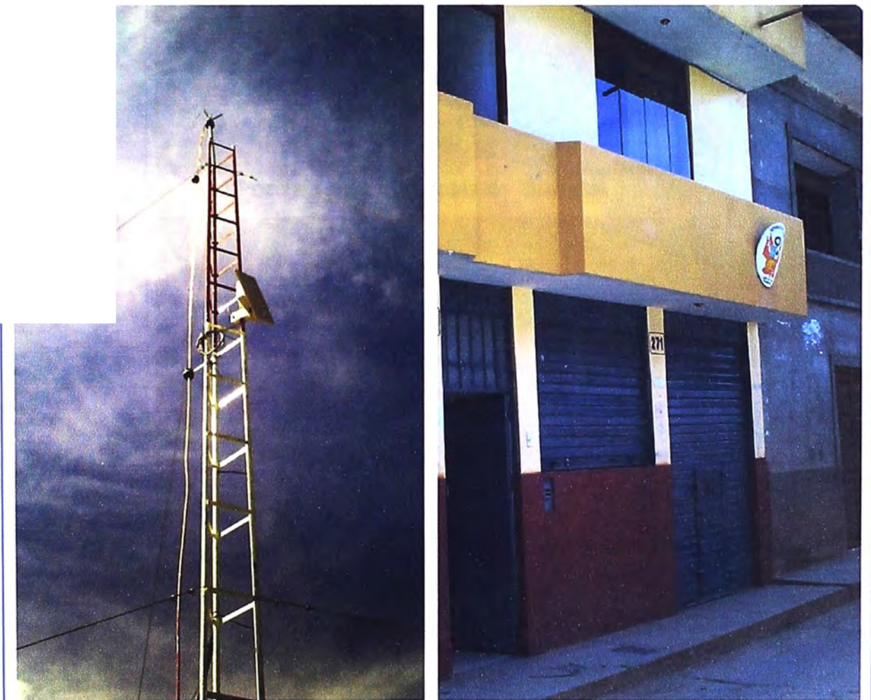
a) Antena Instalada en Torre
