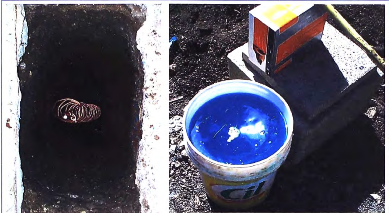
a) Pozo a Tierra
