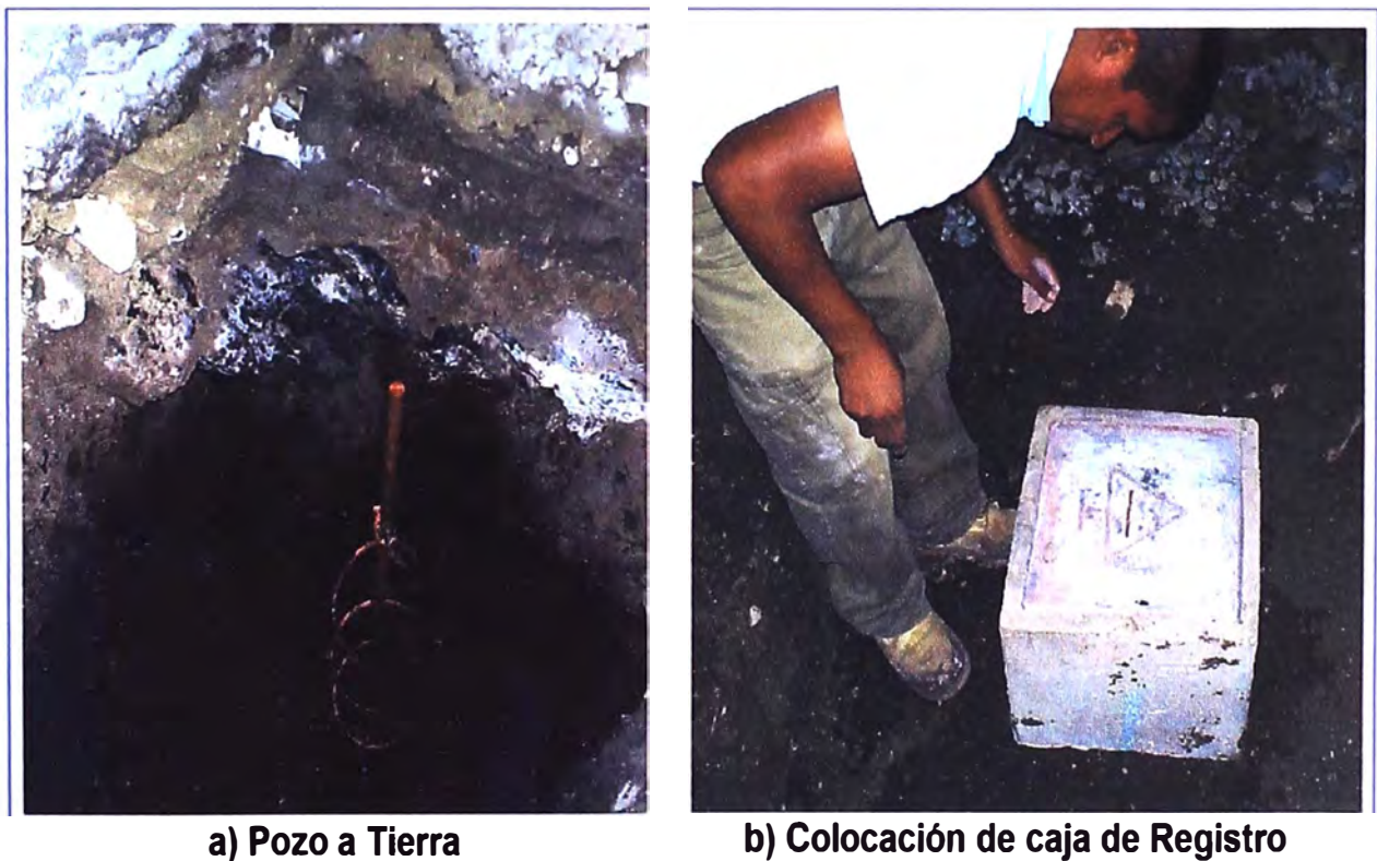
Figura 4.47 Pozo a Tierra Nodo Remoto 2 Abancay
