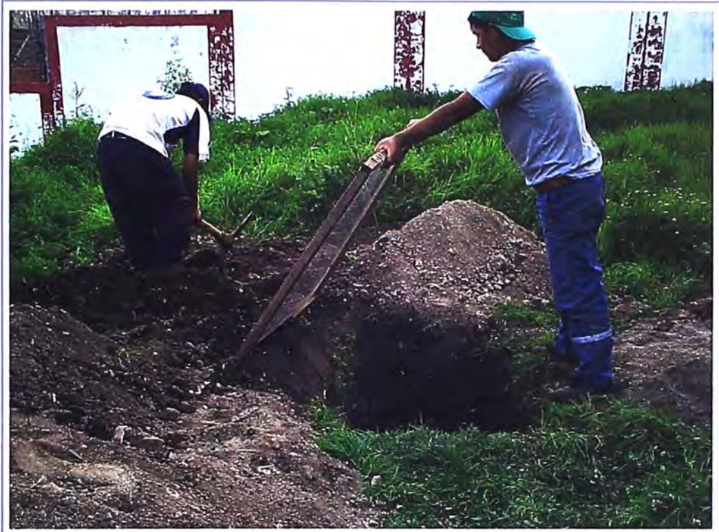
a) Cernimiento de Tierra
