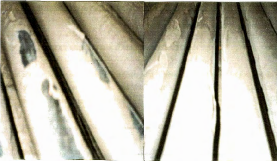
Figura 23. Tubos de caldera pirotubular con incrustaciones cálcicas.
