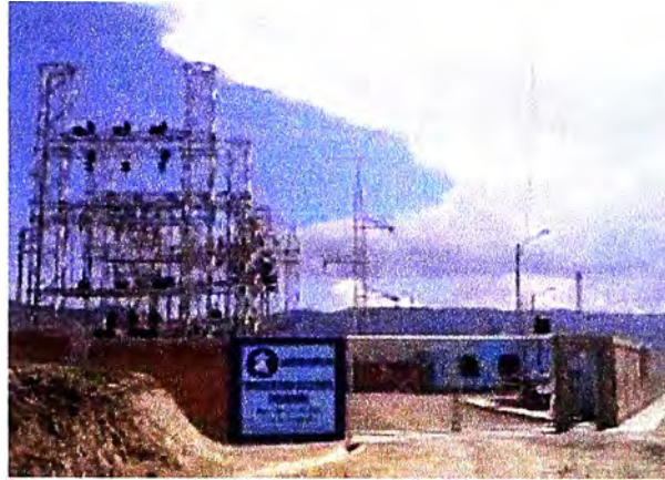
Fig. 1.6 Subestación Coracora 60/22,9/10 kV
