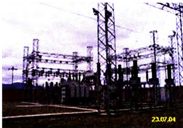
Fig. 1.5 Subestación Puquio 60/22,9/10 kV
