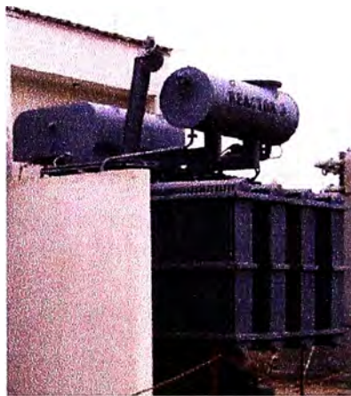
Fig. 1.17 Reactor Shunt en la SE Marcona 10 kV, 5 MVAr
