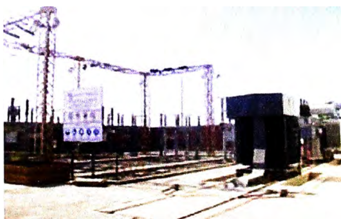
Fig. 1.3 Subestación Nazca 60/22,9/10 kV
