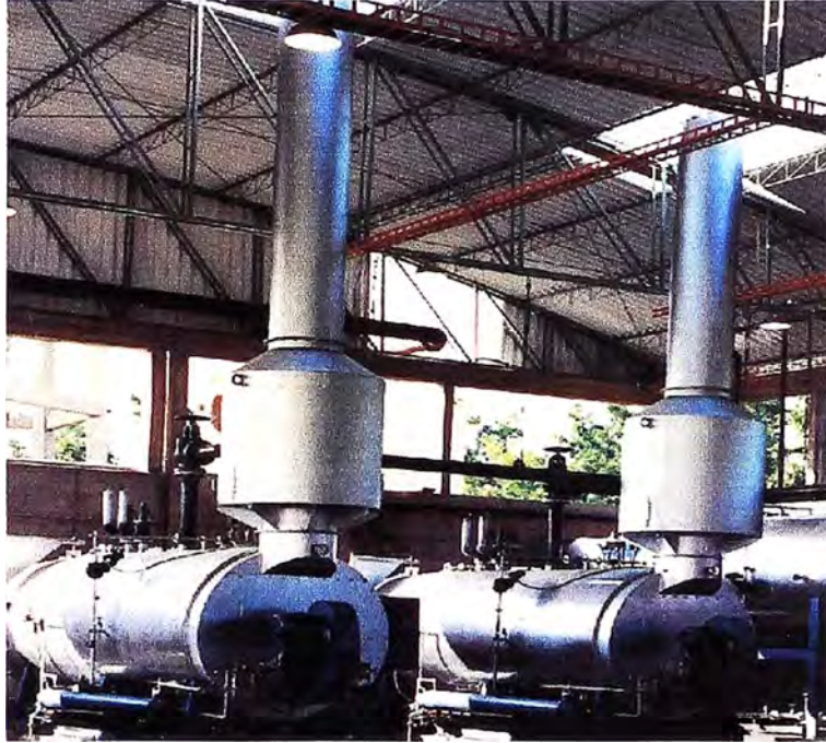
Figura N° 5.30: Vista de chimeneas de las calderas, donde se pueden recuperar energía instalando economizadores.
