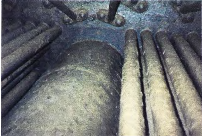
Figura N° 5.35: Encalichamiento de los tubos producto de un mal tratamiento y/o malas condiciones de trabajo
