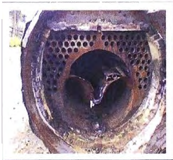
Figura N° 5.34: Deformación del flue por consecuencia de alteración de T del metal.
