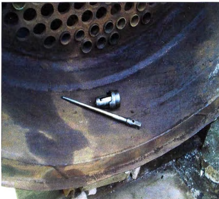
Fig. N° 5.5 : expandidor de tubos internos de pase de los gases de combustión.
