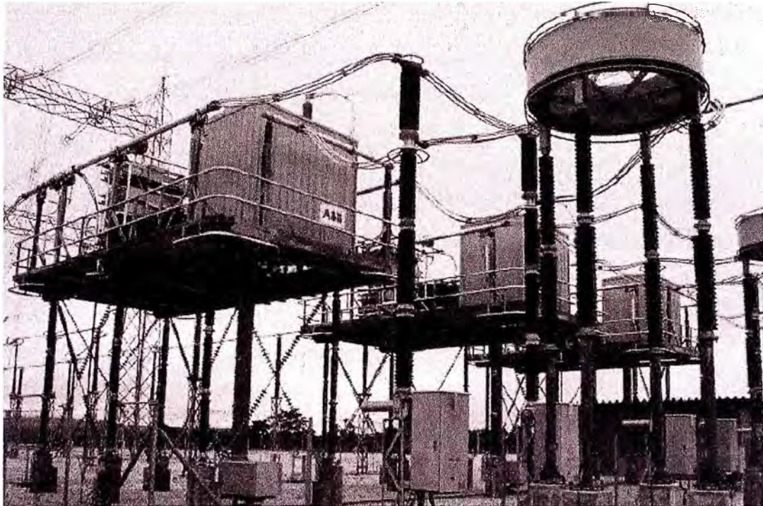
Fig.1.12 Vista panorámica de TCSC [Fuente: ABB]
