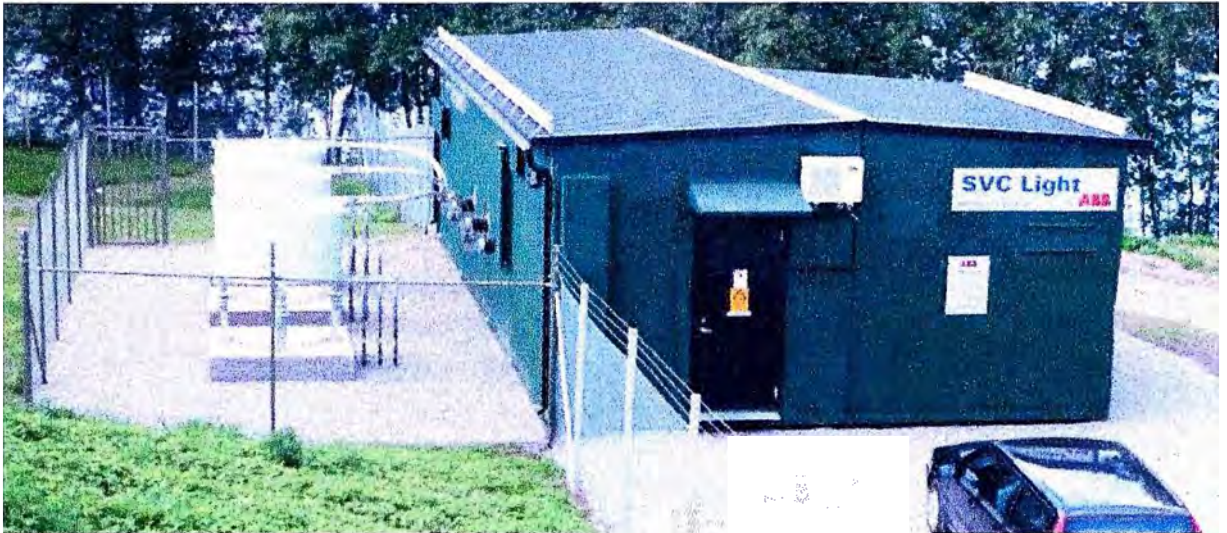
Fig.5.5 Vista exterior de la instalación del SVC Light [Fuente: ABB]
