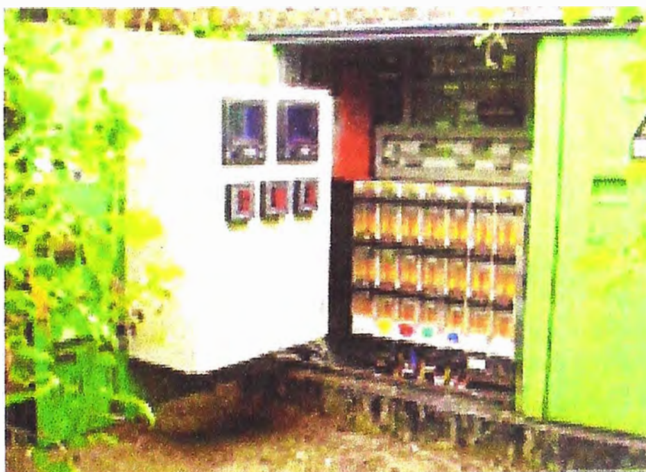
Fig. 8.7: Vista del tablero de distribución de la microrred de Bronsbergen, Holanda
