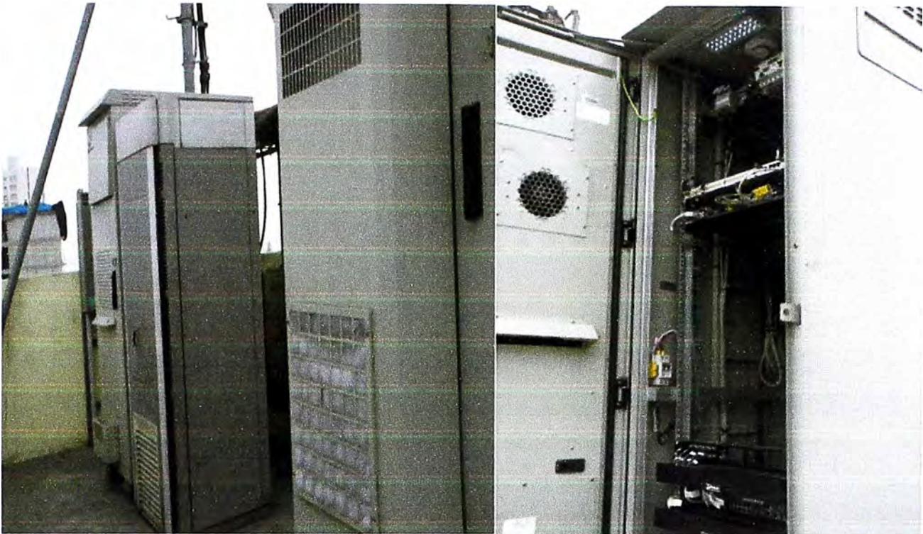
Figura 3.13 Distribución de Gabinetes y espacios dentro de Gabinete de TX (Propia)
