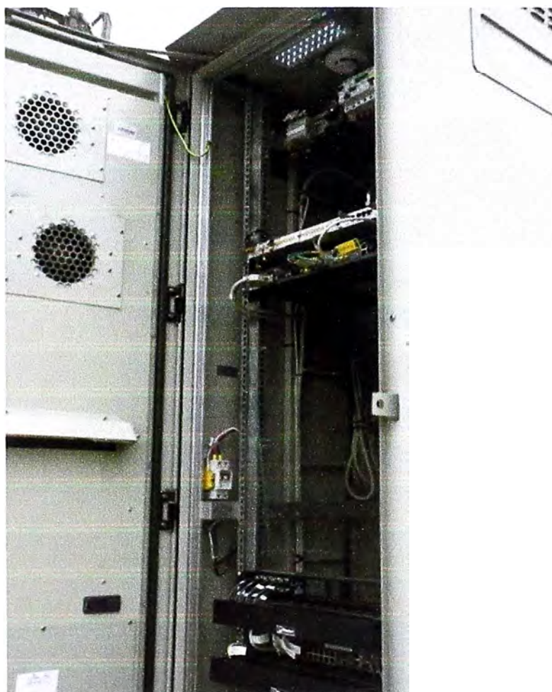
Figura 3.20 Ubicación de Cable de F.O. (Fuente: Elab. Propia)
