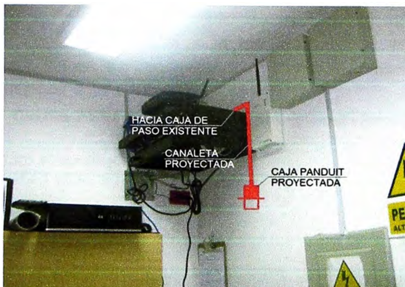
Figura 3.28 Ubicación de Caja Terminal (Fuente: Elab. Propia)
