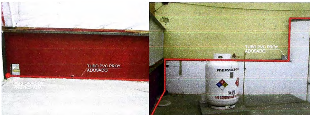
Figura 3.26 Recorrido de FO en Sede Cliente (Fuente: Elab. Propia)
