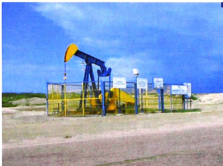
Figura 3.1 Bomba de balancín en instalación actual (Fuente: SKANSKA)
