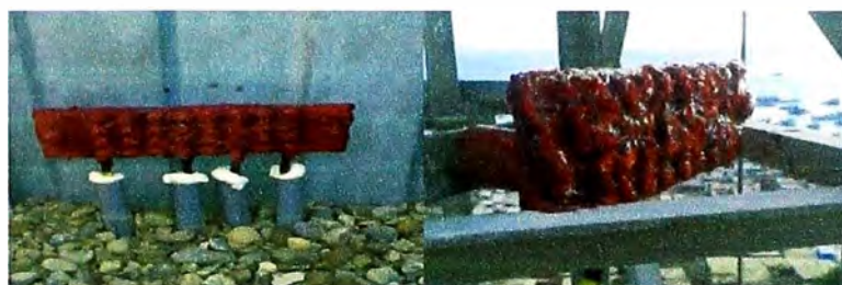
Figura 3.5 Aterramientos: a) Sala; b) Torre (Fuente: Elab. Propia)
