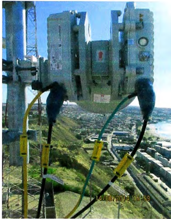
Figura 3.20 Acoplamiento de Unidades ODU XMC2I en el Site Paita_3_1900 (Propia)
