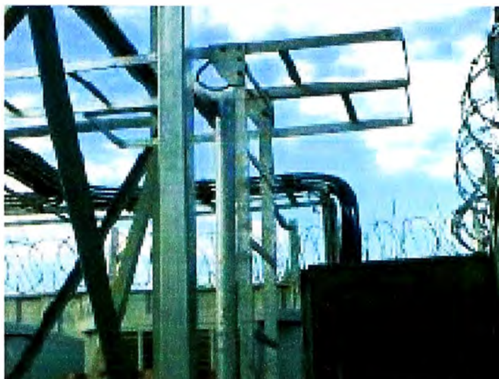
Figura 3.7 Escalerillas: a) Horizontal ( Elevadas)) (Fuente: Elab. Propia)
