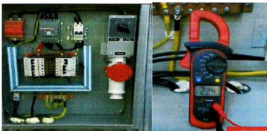
Figura 3.4 Tablero general de conexión monofásico y llaves disponibles y medición de voltaje (Fuente: Elab. Propia)
