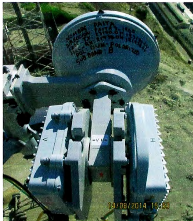
Figura 3.27 Antena(Fuente: Elab. propia)
