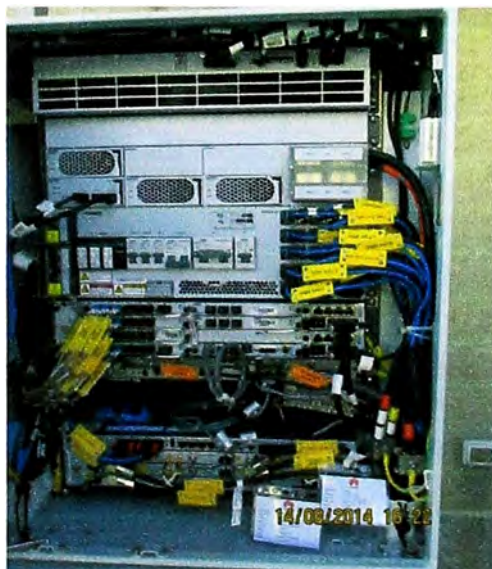
Figura 3.19 Gabinete APM30 en estación Paita (Fuente: Elab. propia)
