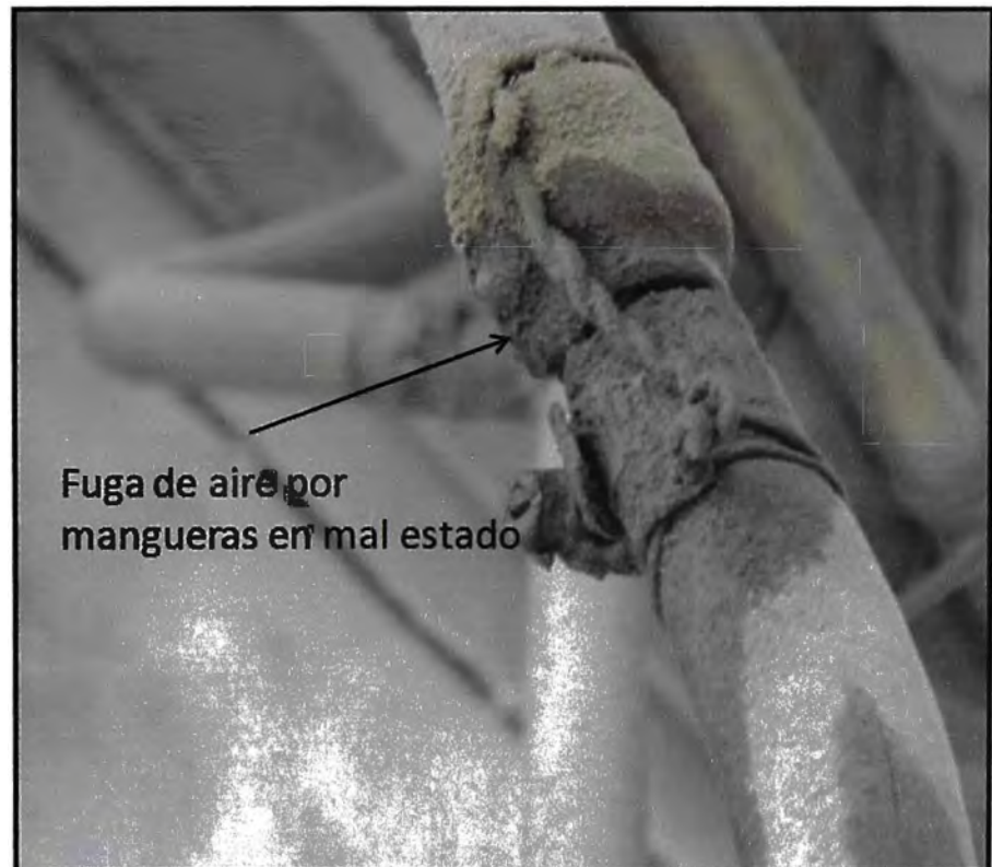
Figura N° 20: Fuga de aire por mangueras en mal estado
