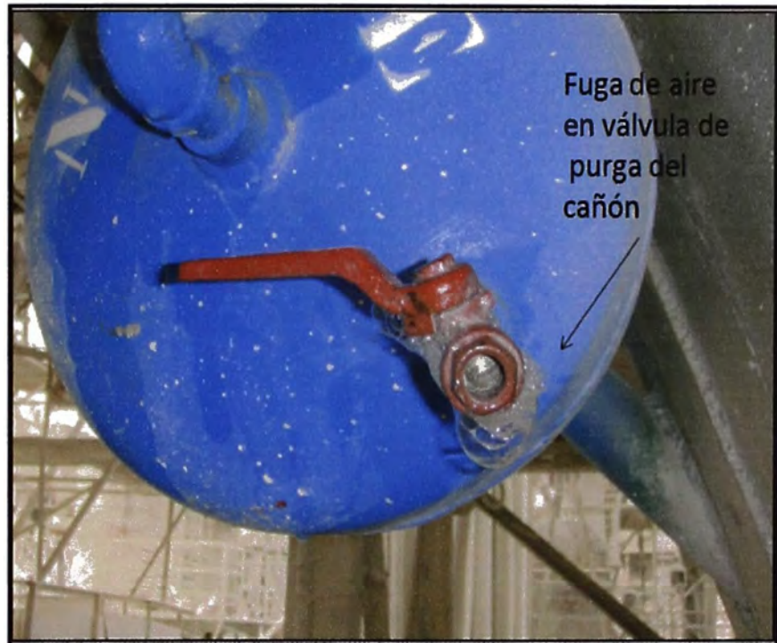
Figura N° 21: Fuga de aire en la válvula de purga del cañón Ciclón 4
