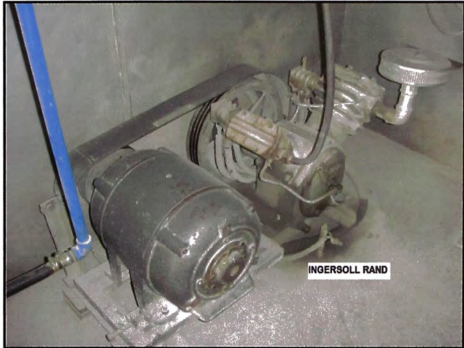
Figura N° 13: Compresor Ingersoll Rand
