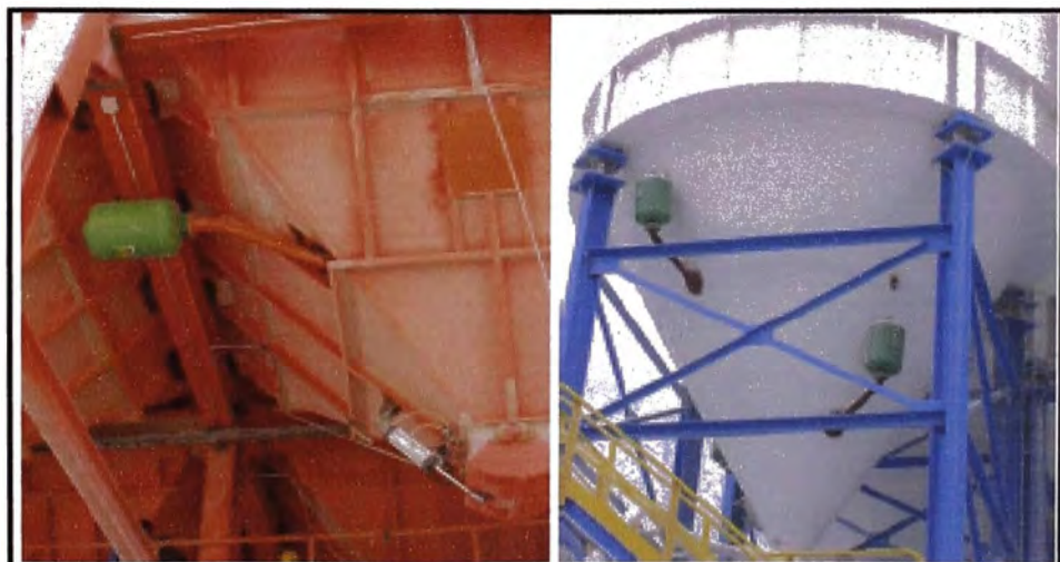
Figura N° 6: Uso de cañones en descarga de tolvas de material fino
