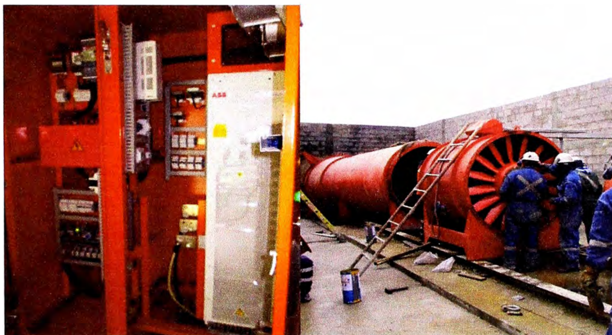
Figura 3.14 Variador y ventiladores de extracción de gases del socavón
