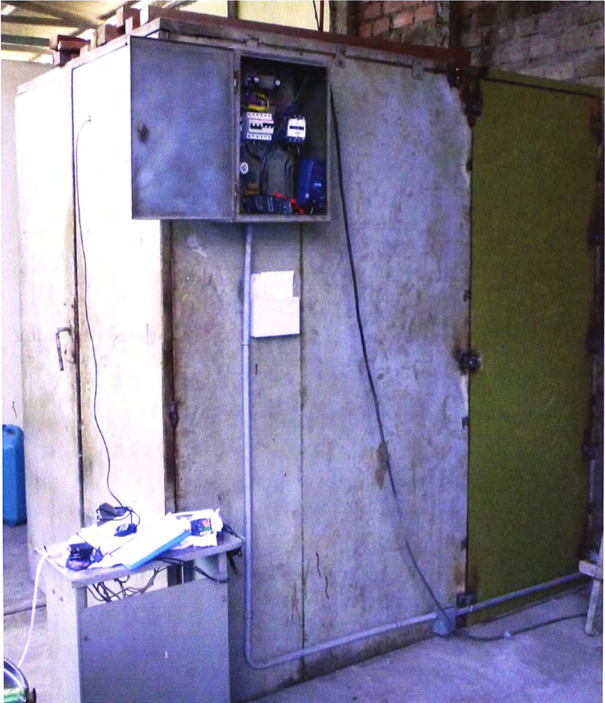
Figura 1.6 – Horno con sistema de control original
