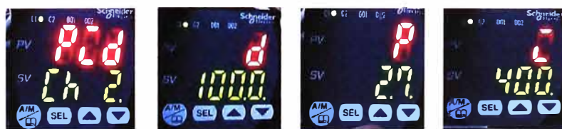
Figura 3.6 Display del Controlador – Parámetros PID
