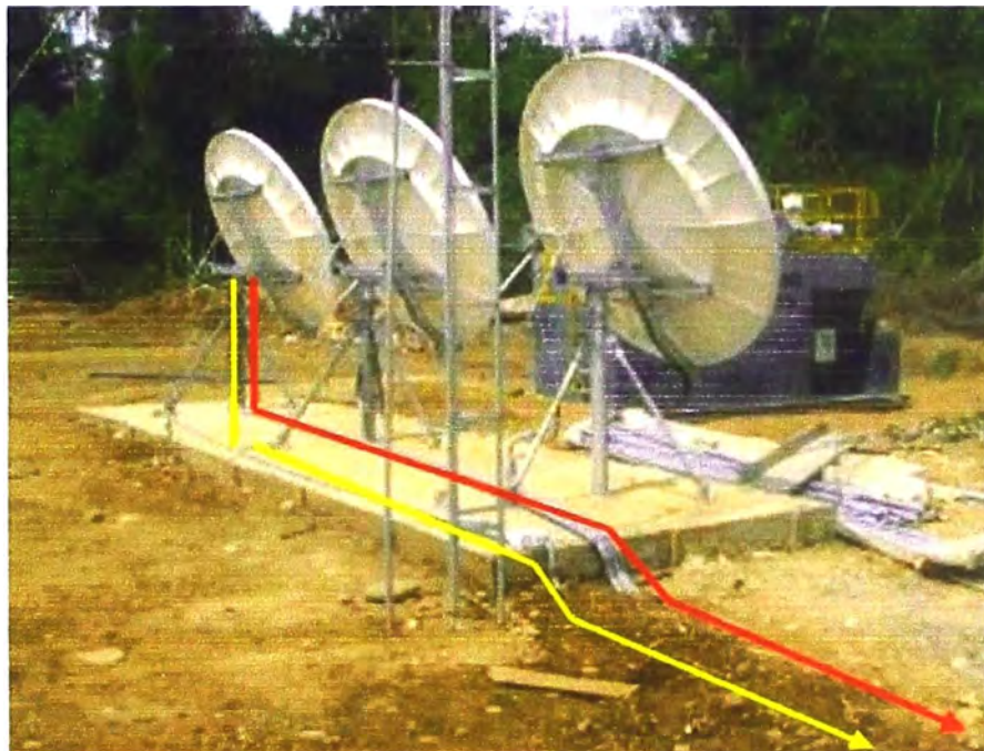
Figura 2.13 Loza de cemento de soporte y tres antenas satelitales (Fuente: Propia)
