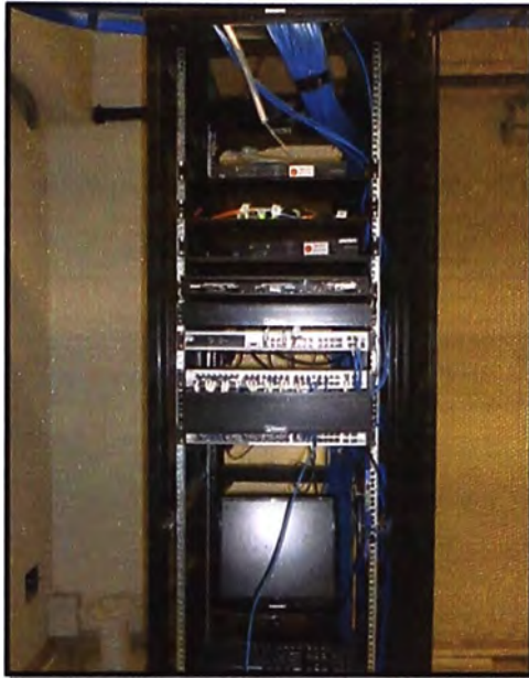
Figura 3.39 Panel de Router, Switch y Proxis en Sede Olivos (Fuente: Red ICH)
