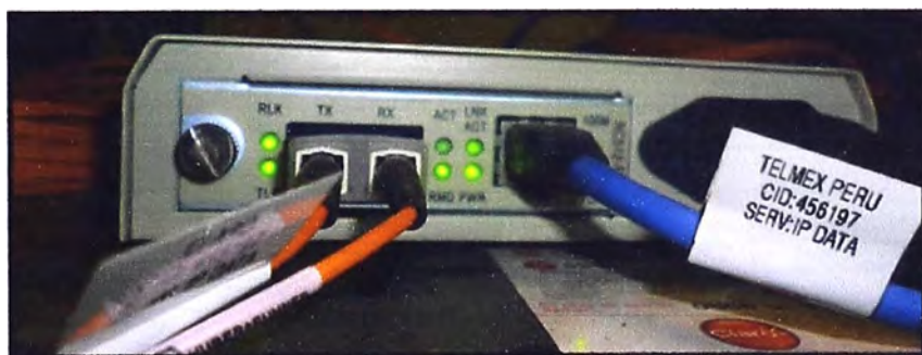
Figura 3.3 Conversor de fibra óptica a RJ45 (Fuente: Red ICH)
