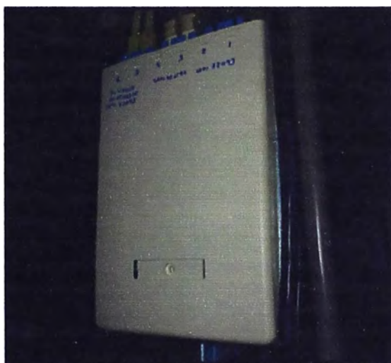
Figura 3.2 Equipo redistribuidor de fibra óptica (Fuente: Red ICH)
