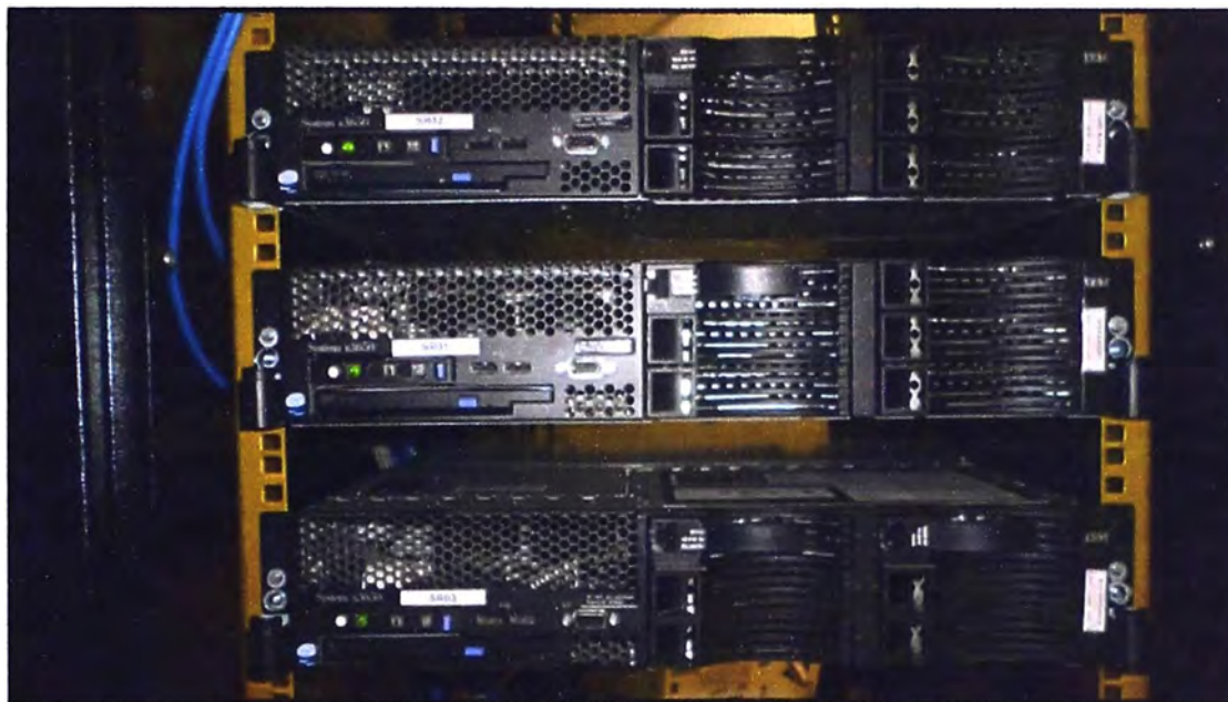
Figura 3.8 Servidores IBM System 3650 en el Data Center ICH (Fuente: Red ICH)
