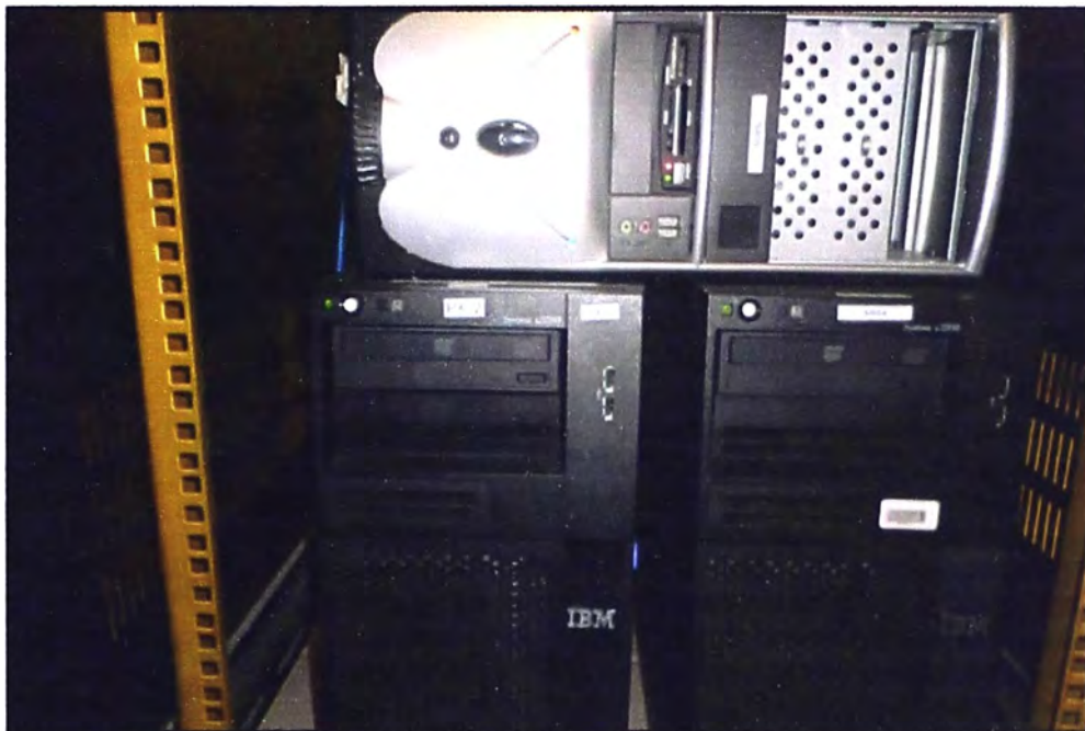
Figura 3.9 Servidores IBM System 3200 (Fuente: Red ICH).
