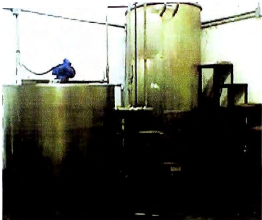
Figura 3.5 Tanque Auxiliar (izq.) y Tanque Preparación (der.)
