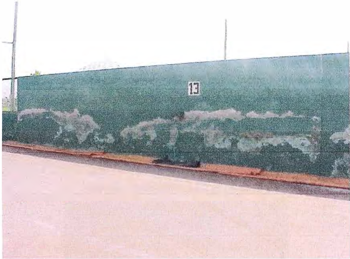
Figura 8.3: DAÑOS DEL SALITRE EN UNA PARED
