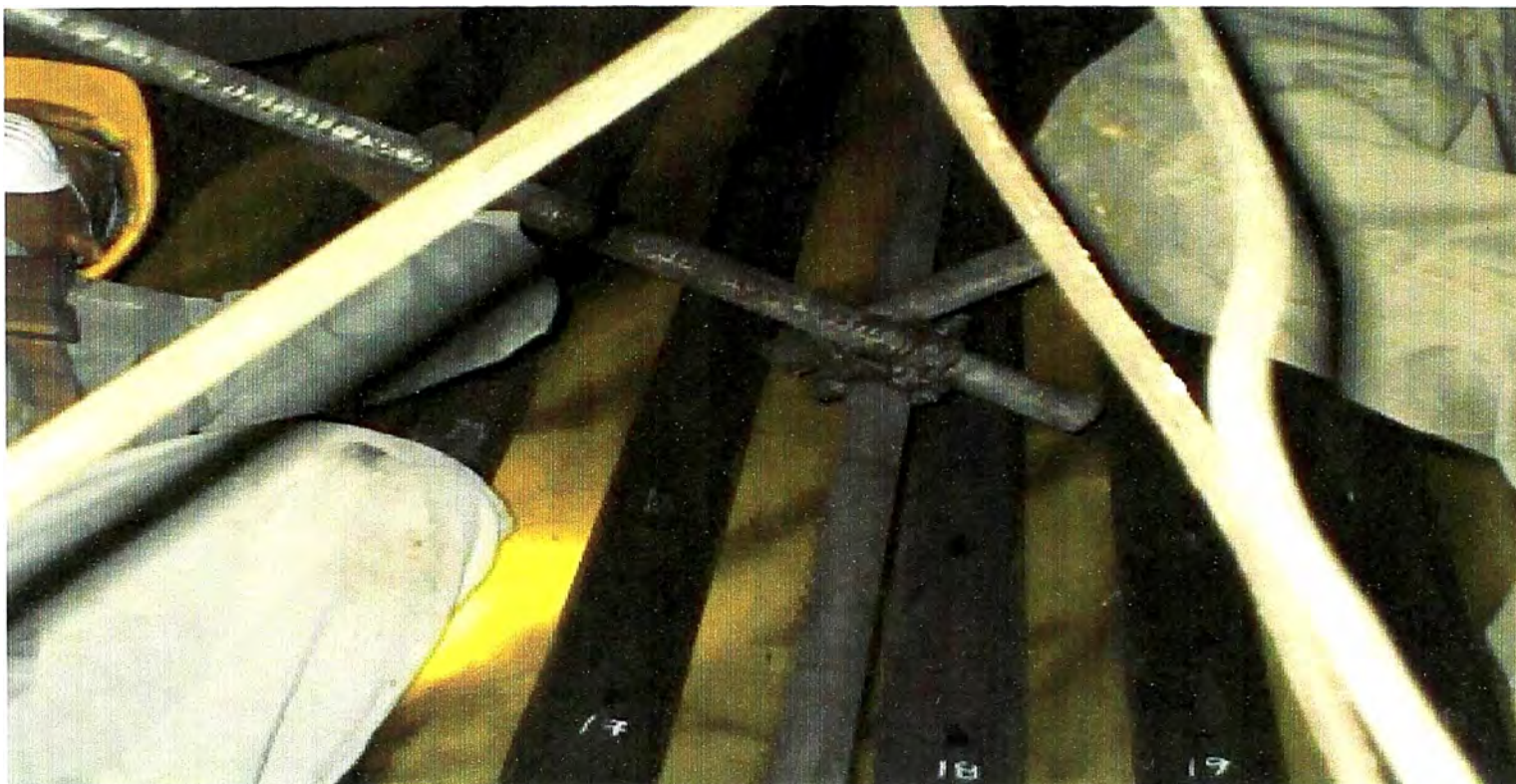
Fotografía N°9 : TUBOS DE LA ZONA RADIANTE DEL HORNO F-1.
