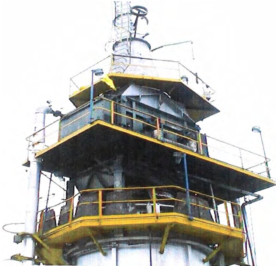
Fotografía N°4 : VISTA EXTERIOR DEL HORNO F-2.
