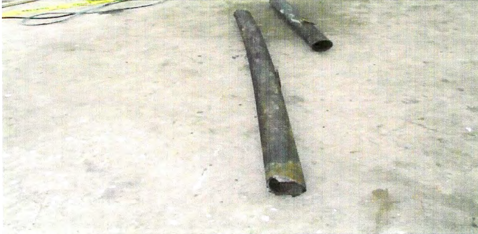
Fotografía N°12: DETERIORO DE TUBO DE LA ZONA RADIANTE HORNO F-2 POR ACCION DE LAS CENIZAS FUNDIDAS.
