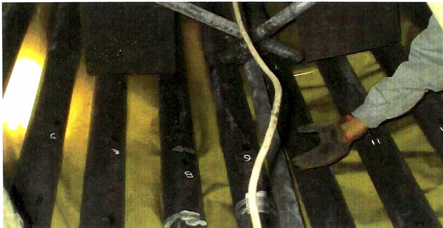
Fotografía N°8: SERPENTÍN DE TUBOS DE LA ZONA RADIANTE DEL HORNO F-1.
