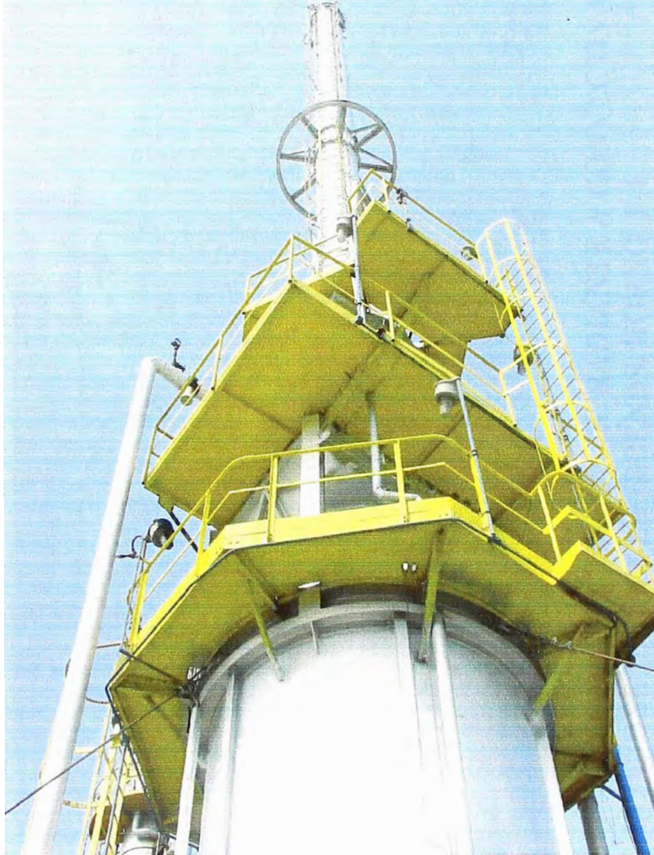
Fotografía N° 2 : (De abajo hacia arriba) ZONA RADIANTE, CONVECTIVA Y CHIMENEA DEL HORNO F-1.
