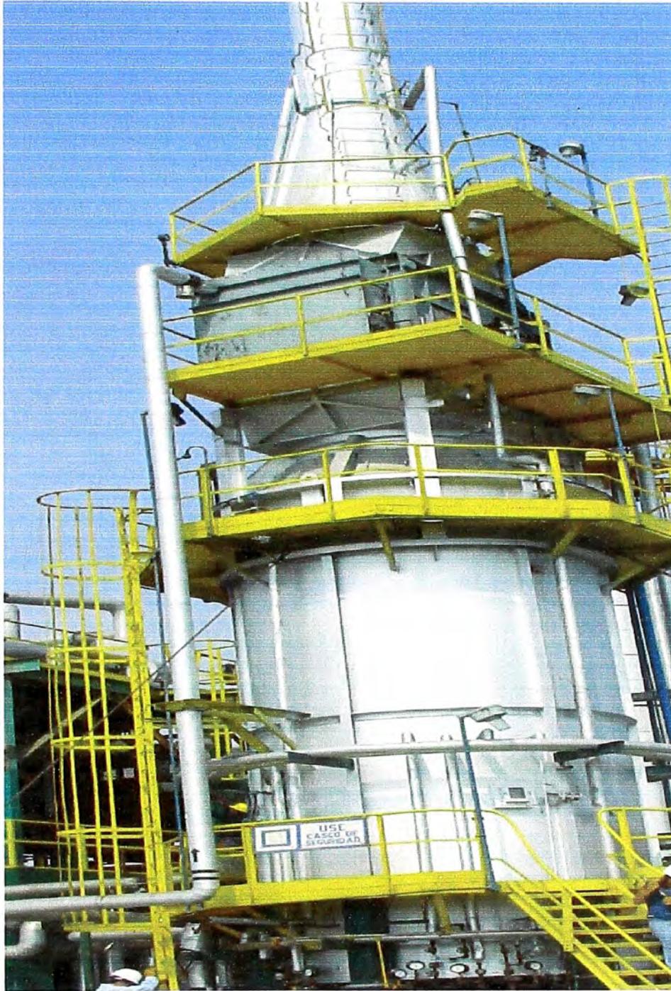
Fotografía N° 1: VISTA EXTERIOR DEL HORNO F-1.
