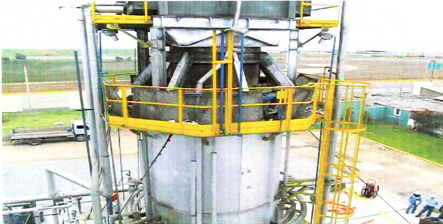
Fotografía N°3 : ZONA DE TRANSICION DE RADIANTE A CONVECTIVA DONDE SE UBICAN LA H-BENDS. HORNO F-1.
