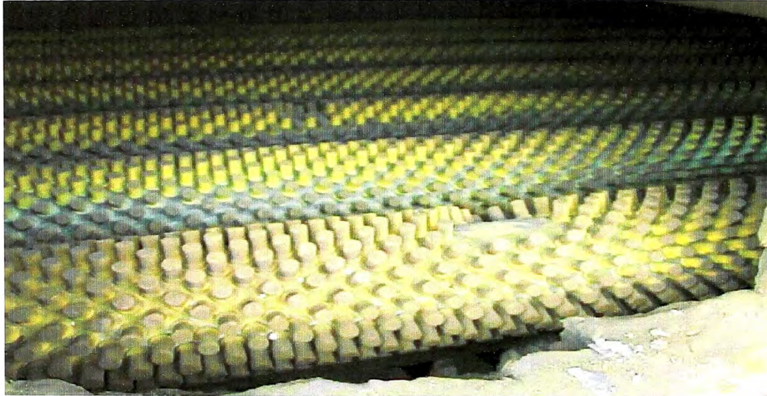
Fotografía N°10 : TUBOS HORIZONTALES DE LA ZONA CONVECTIVA DEL HORNO F-1.
