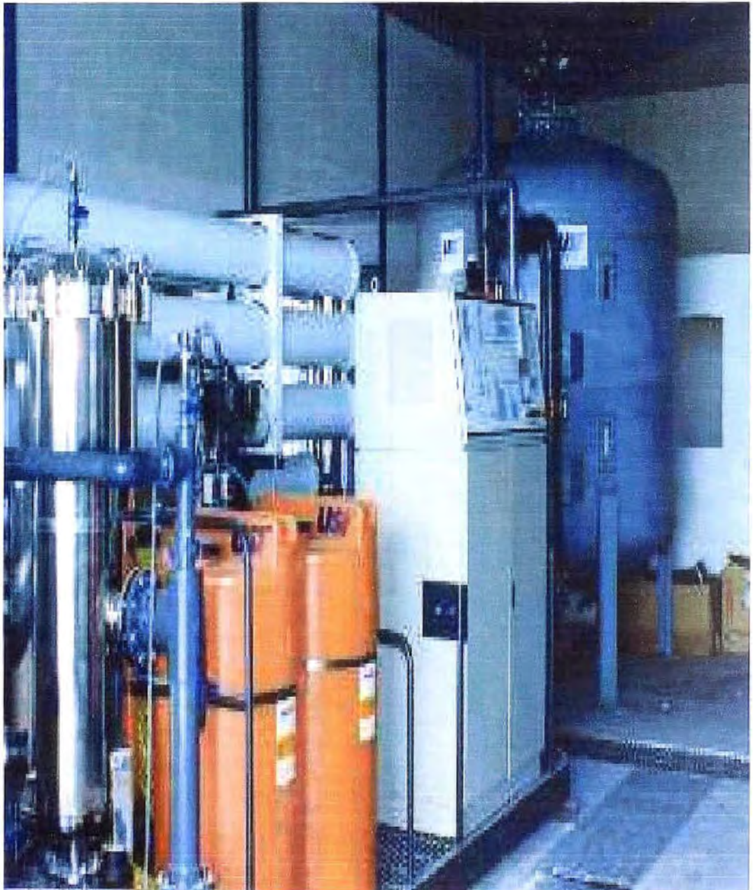
FIGURA N° 28. Equipo de Osmosis Inversa.
