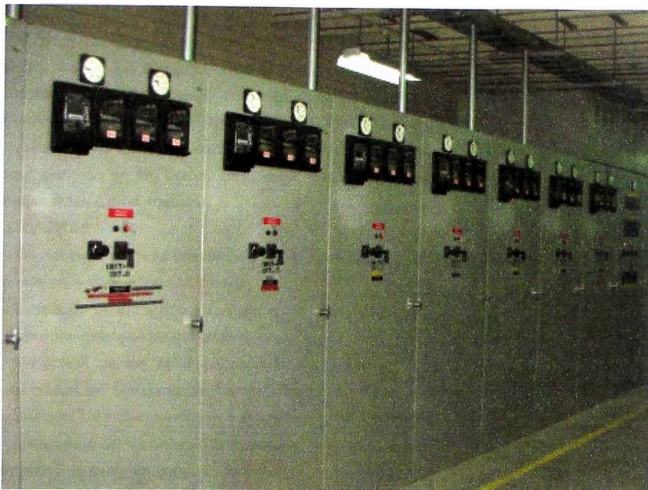
Figura.4.12 Acabado final de las celdas de la barra I - 13.8 kV
