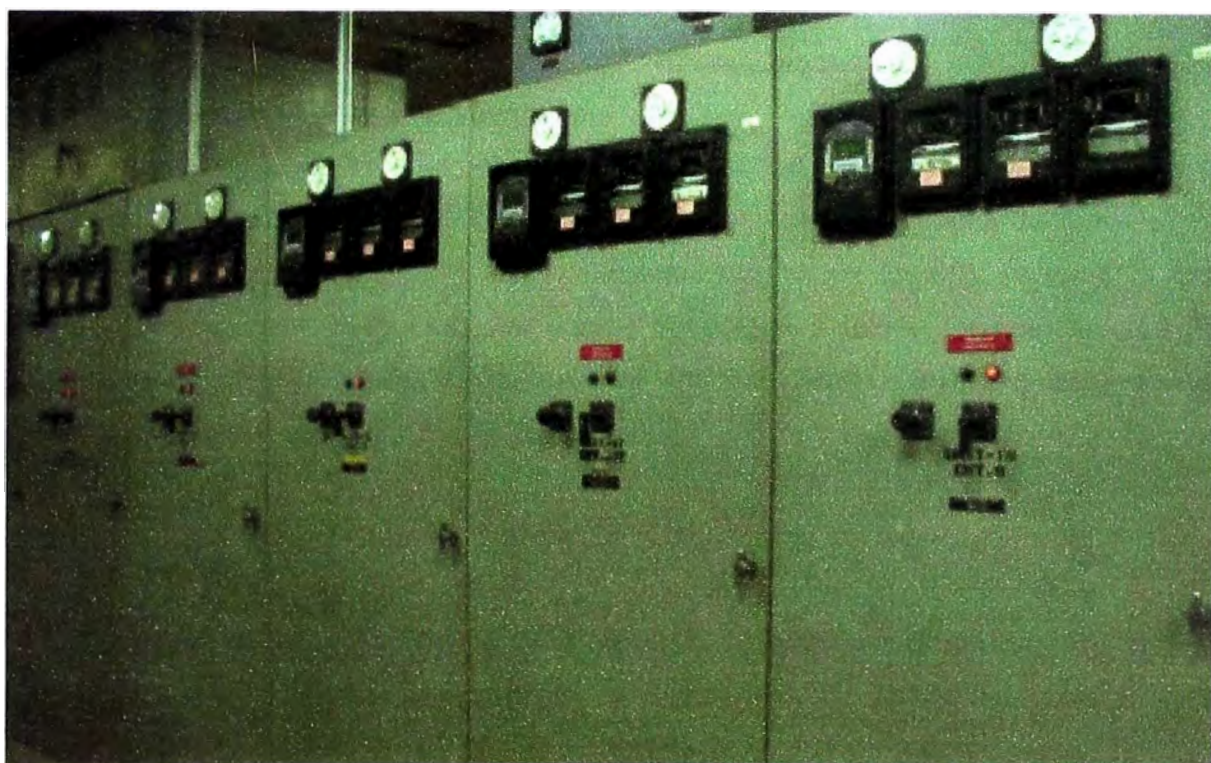
Figura 4.13 Acabado final de las celdas de la barra II - 13.8 kV
