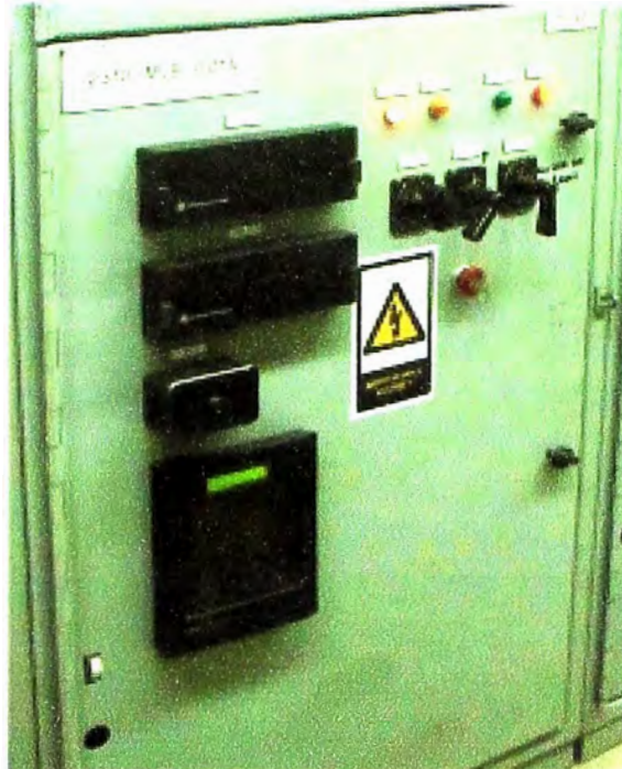
Figura 4.5 Celda de la barra III – antes
