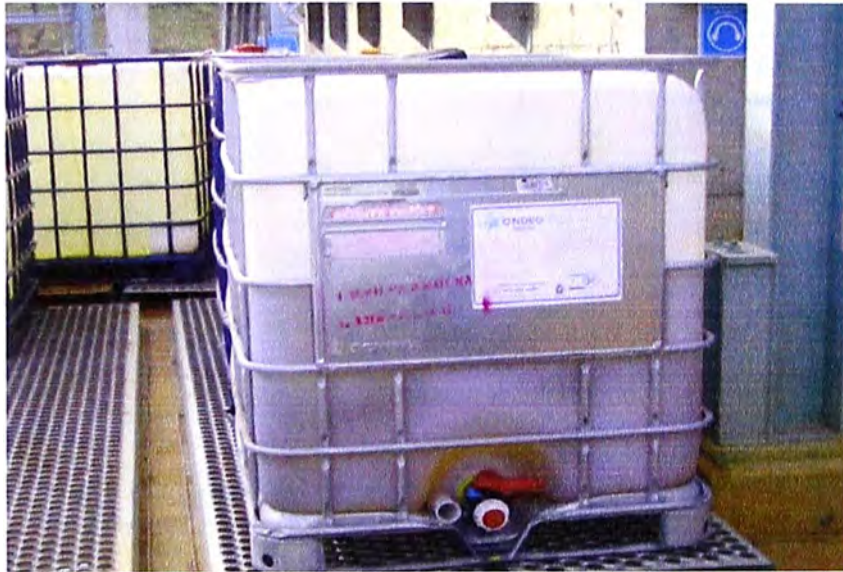
TANQUE DE PRODUCTO QUÍMICO
