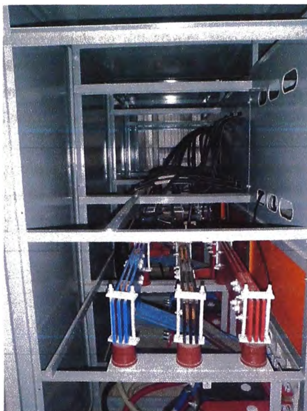
Fig.2.3: Fotografía de la Vista interna del Tablero General TG-100-01.
