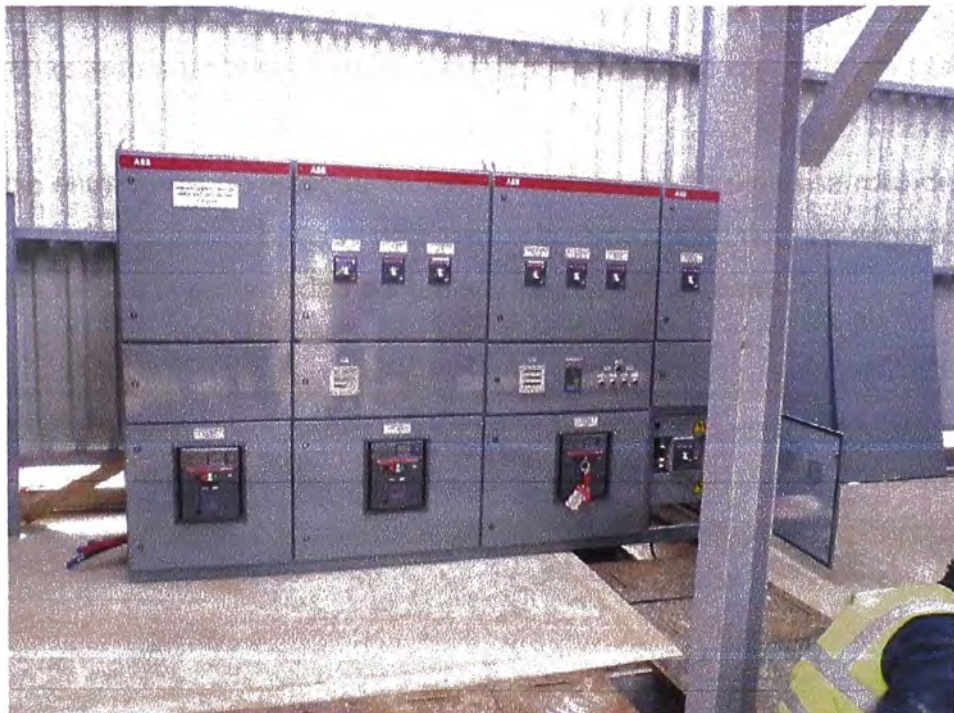
Fig.2.2: Fotografía de la Vista Frontal del Tablero General 100-TG-001
