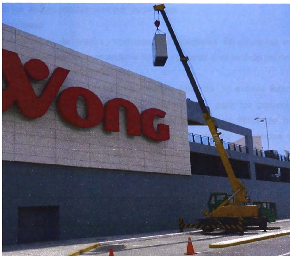
Figura 4.13 Vista de elevación de banco de condensadores para montaje en Azotea.
