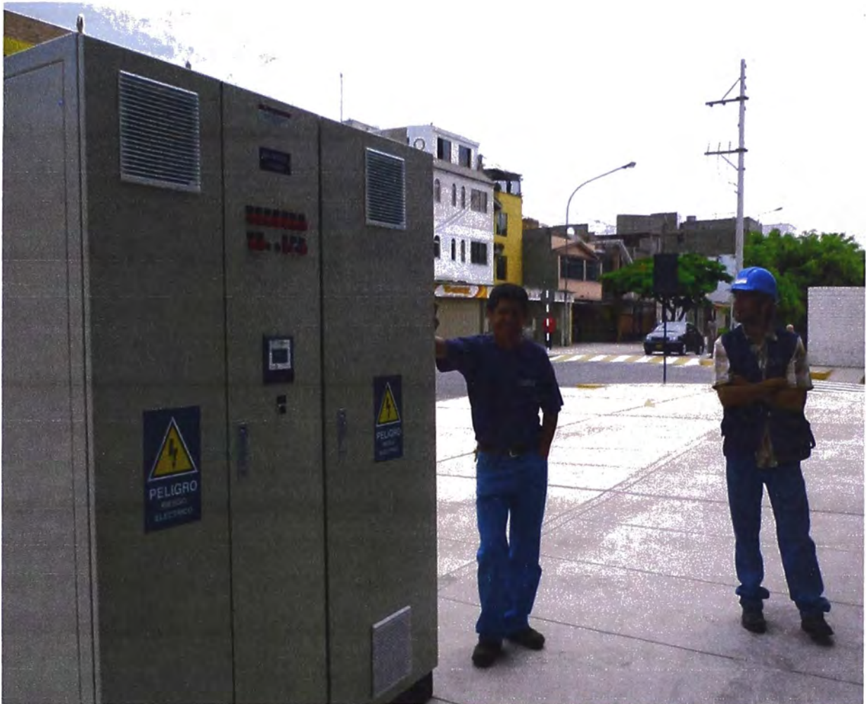
Figura 4.11 Vista de banco de condensadores llegada en destino.(centro comercial)
