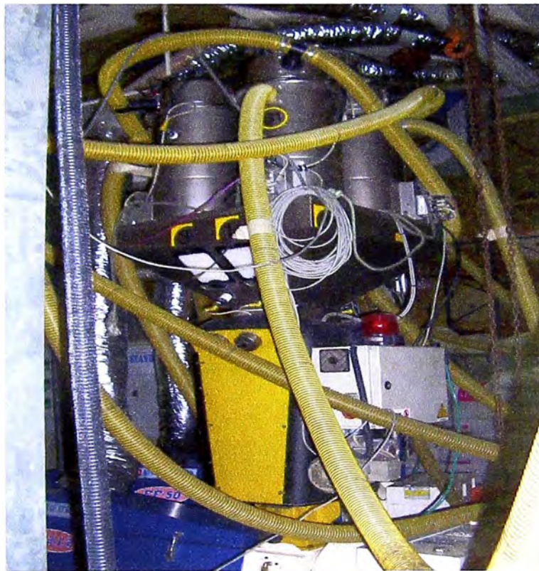
Figura N° 9: Tolva con Sistema de alimentación Volumétrico.
