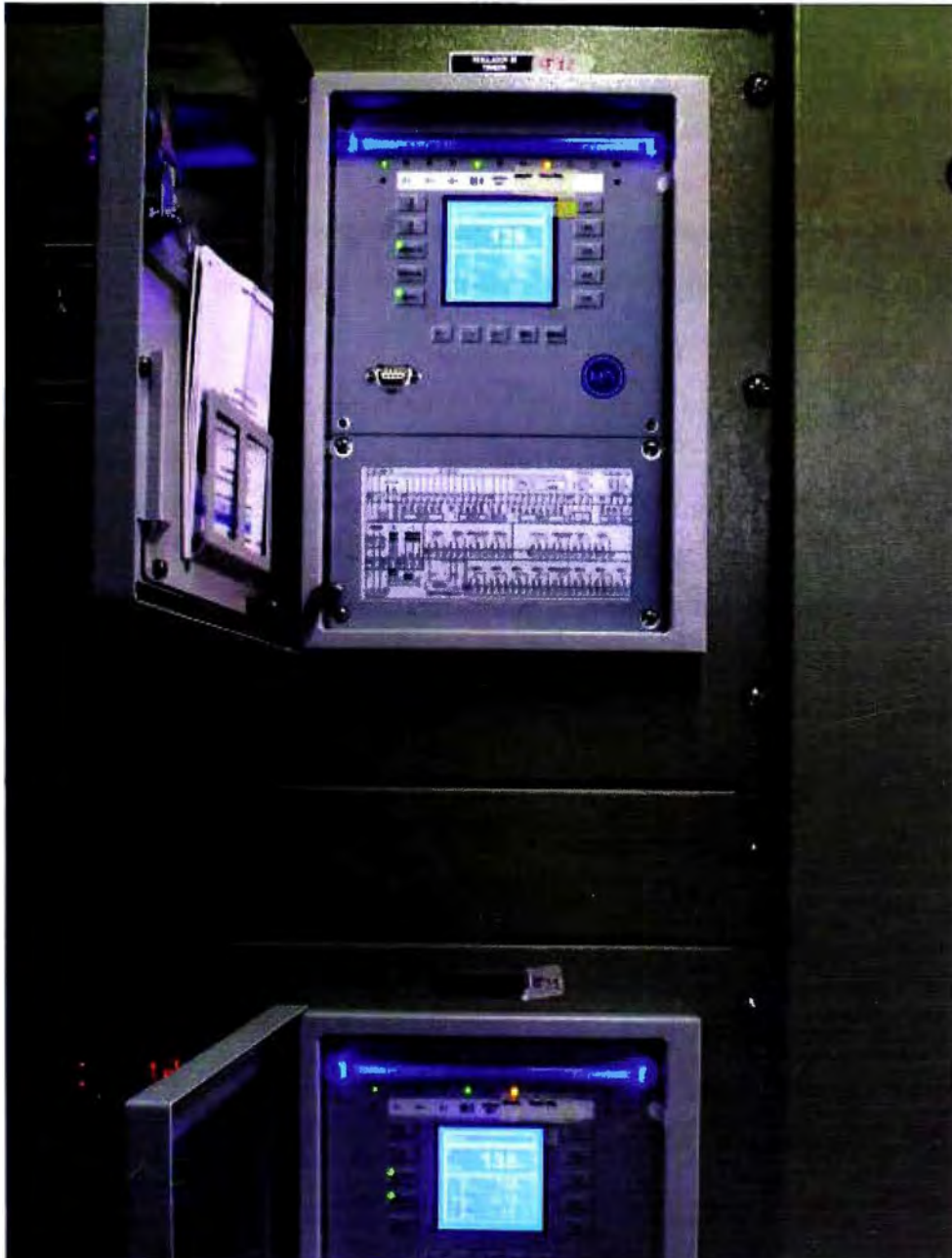
Fig. 4.1 Nuevo tablero de regulación para los transformadores AT12, AT31 y AT99 de la subestación Trujillo Norte
