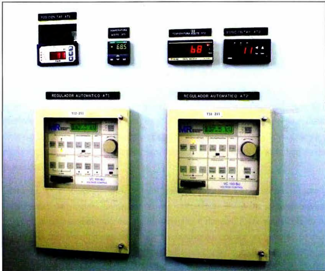
Fig. 1.1 Tablero de regulación de los transformador AT12-211 (142.3 kV) y AT31-211 (137.5 kV), SE Trujillo Norte (fotografía del 05-feb-2014)
