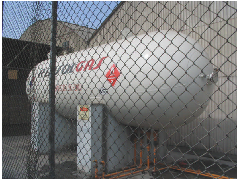
Figura 4.3 Tanque de GLP de 5500 galones
