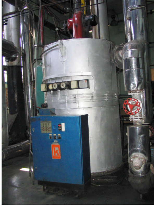
Figura 4.8 Caldero de aceite térmico 930 kW
