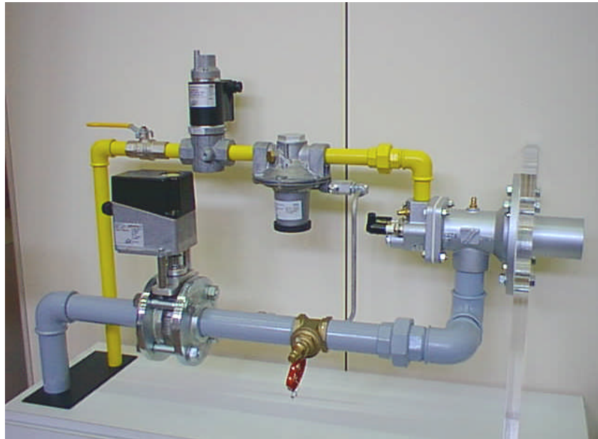
Figura 3.18 Tren de válvulas instalado de un quemador
