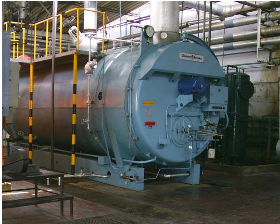
Figura 4.7 Generador de Vapor 800 BHP Cleavers Brooks
