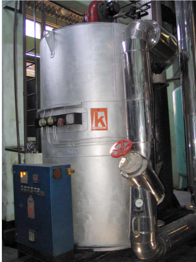
Figura 4.11 Caldero de aceite térmico 1453 kW
