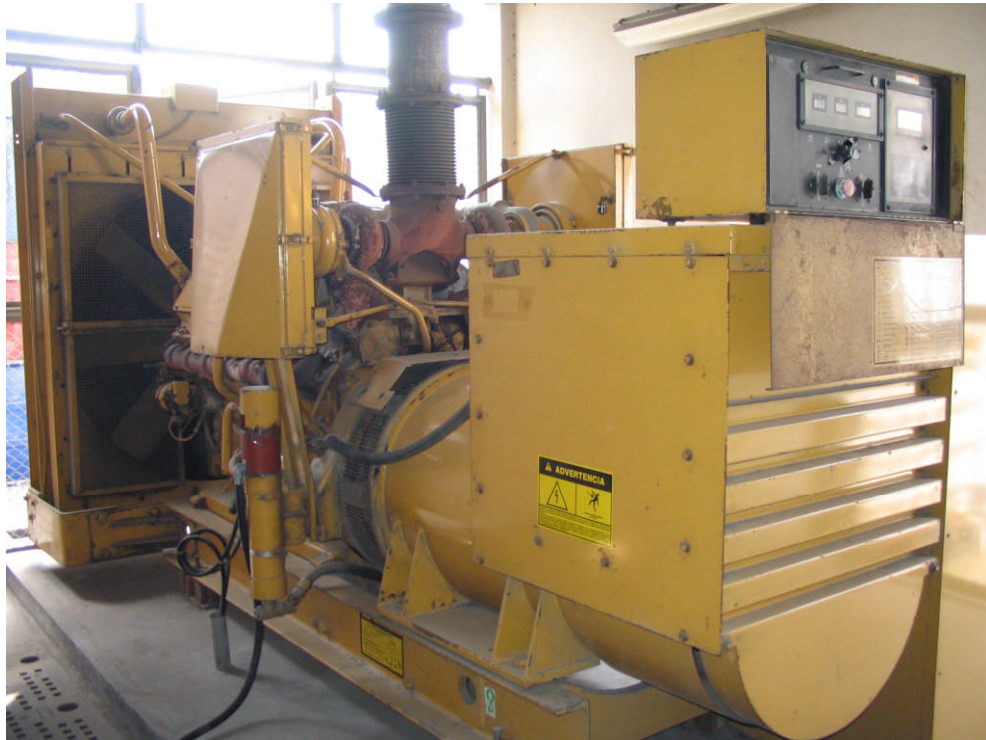
Figura 4.15 Grupo electrógeno 600 kW
