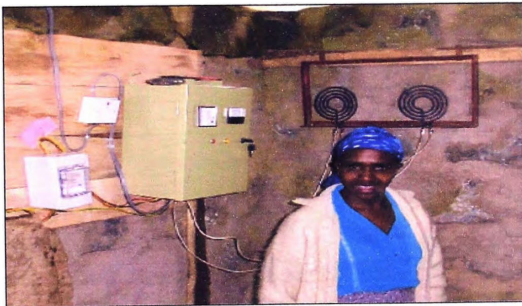
Fig. C.5 Dos hornillas de cocina usados como resistencia de regulación
