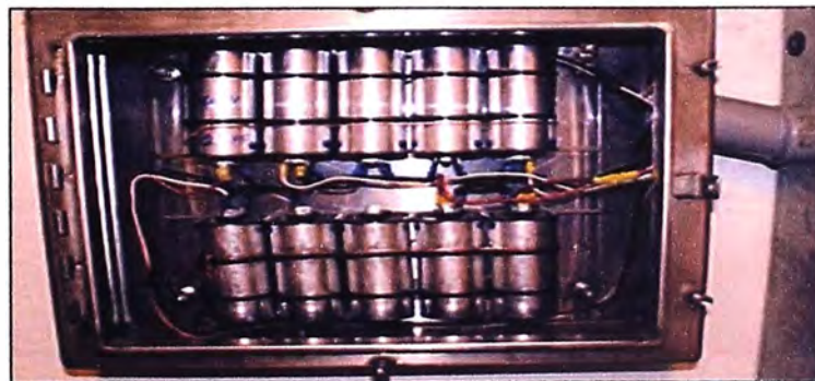
Fig. C.3 Banco de condensadores
