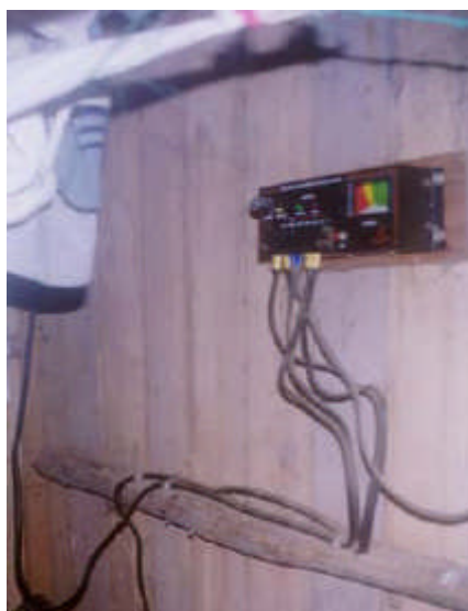
CONTROLADOR ELECTROMECAÁNICO INSTALADO EN SAN FRANCISCO, UCAYALI
