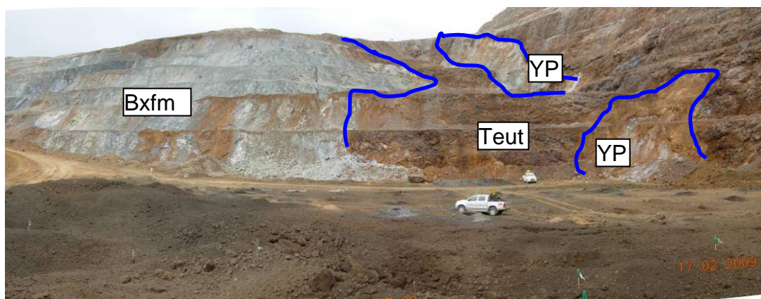
Fig. 20: Dique porfirítico argilizado (Yp) cortando la secuencia de tufos TEUT, hacia el oeste obsérvese el cuerpo de brecha freatomagmática BXFM totalmente argilizado (foto mirando al Norte).
