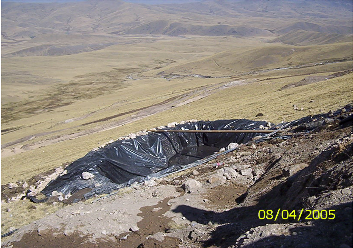
Foto 3: Poza para la recepción de lodos de perforación cubierta con una capa de plástico grueso para evitar la infiltración al suelo.
