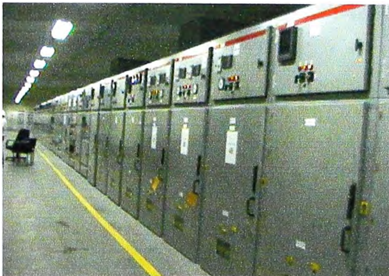
Fig. 3.5 Celdas de la Subestación Principal
