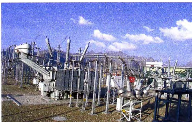
Fig. 3.4 Subestación Principal Antamina
