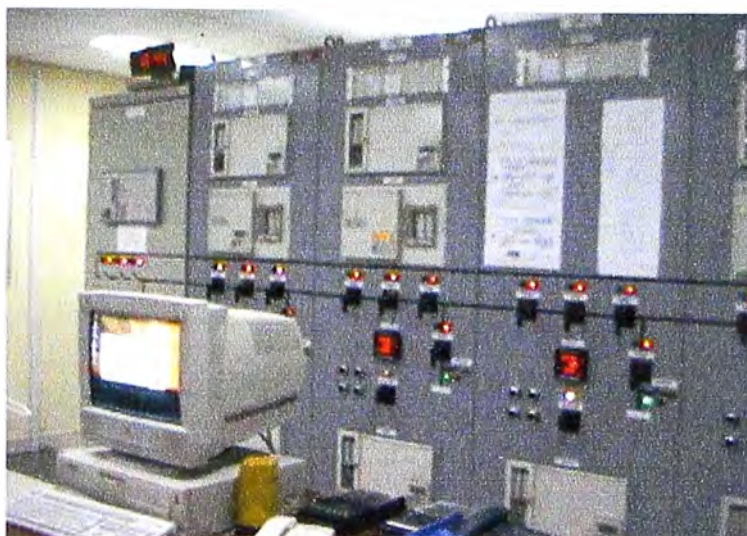
Fig. 3.3 Celdas de la Subestación Vizcarra
