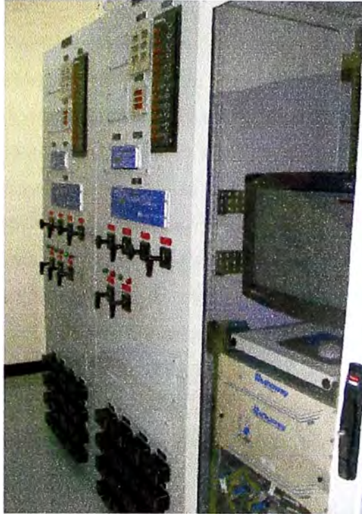
Fig. 1.6 Sistema de Automatización de Subestación Principal
