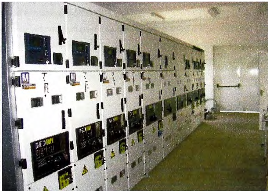
Fig. 1.3 Equipos de Protección y Control de una Subestación de Distribución
