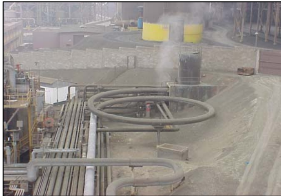
Fig. 14 : Calderas de recuperación de calor.
