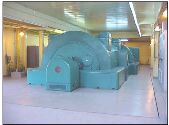
Fig._13 : Turbina de vapor N°4.
