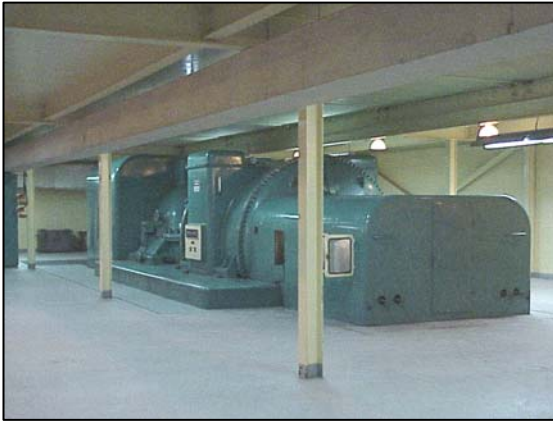
Fig._10 : Turbina de vapor N°1.
