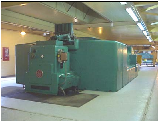
Fig._12 : Turbina de vapor N°3.
