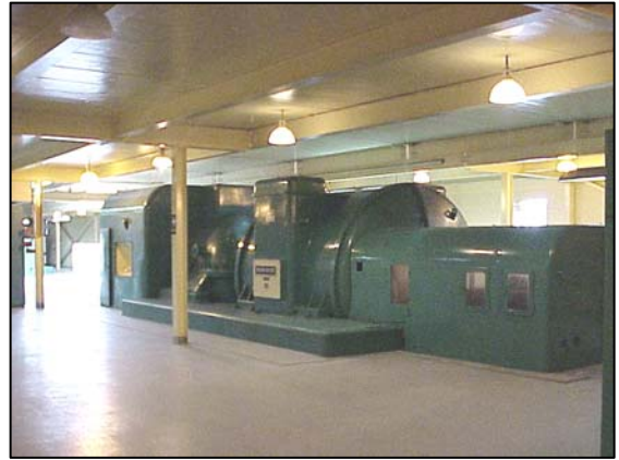
Fig._11 : Turbina de vapor N°2 .
